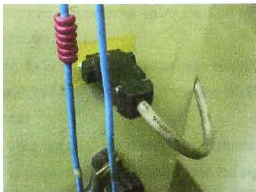
Figura 4.6 Terminal de comunicación serial
