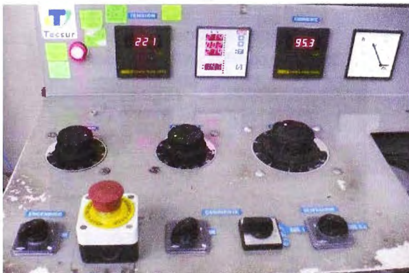
Figura 4.8 Panel de control del banco de medidores
