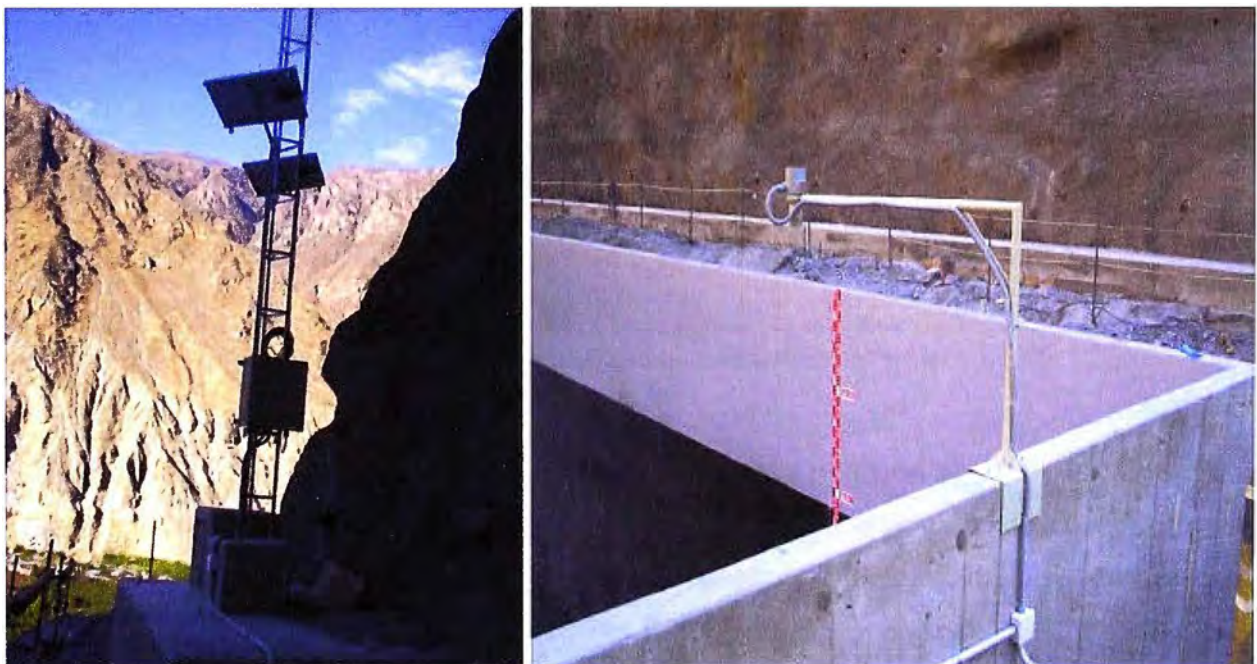
Figura 3a. Fotografías de estación transmisora y sensor de nivel
