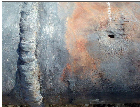
Figura 2 Corrosión por picadura en acero al carbono.
