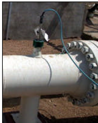
Figura 12 Probeta de corrosión en una tubería de proceso
