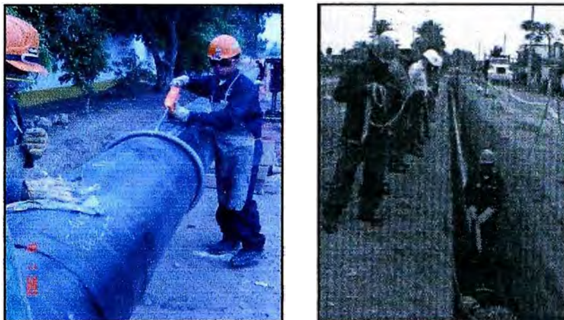
Fig. 2.21 Prueba de holiday detector antes de bajar el varillón y dentro de la zanja
