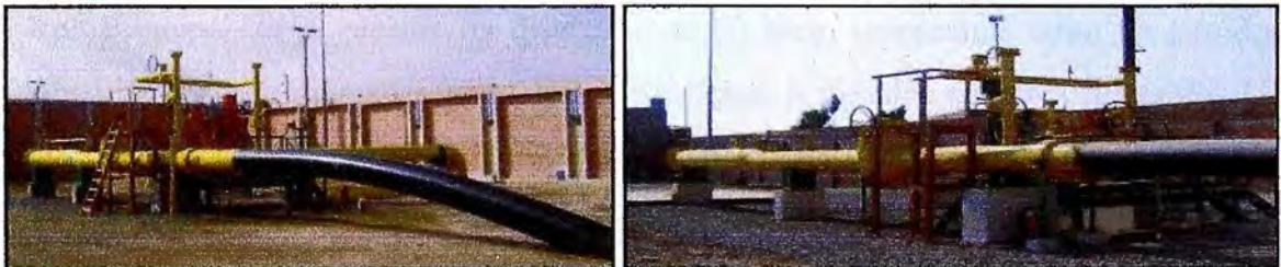
Fig. 2.5 Fotos, Trampa de Lanzamiento – Lurín (Costado estación City Gate) y Trampa de Recepción – Callao (Costado estación Terminal)
