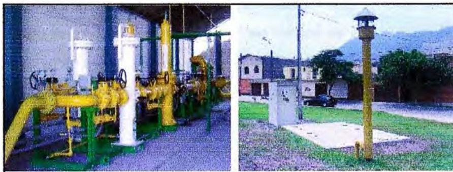
Fig. 2.6 Foto, Estación reguladora de presión y Válvula de línea
