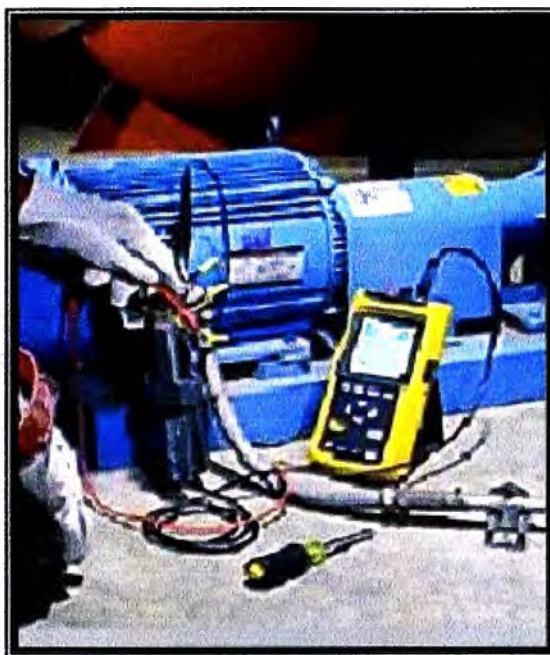
Figura 2.1 Medición de Parámetros Operación y Consumo kW,kVAR, V, I, \cos \phi
