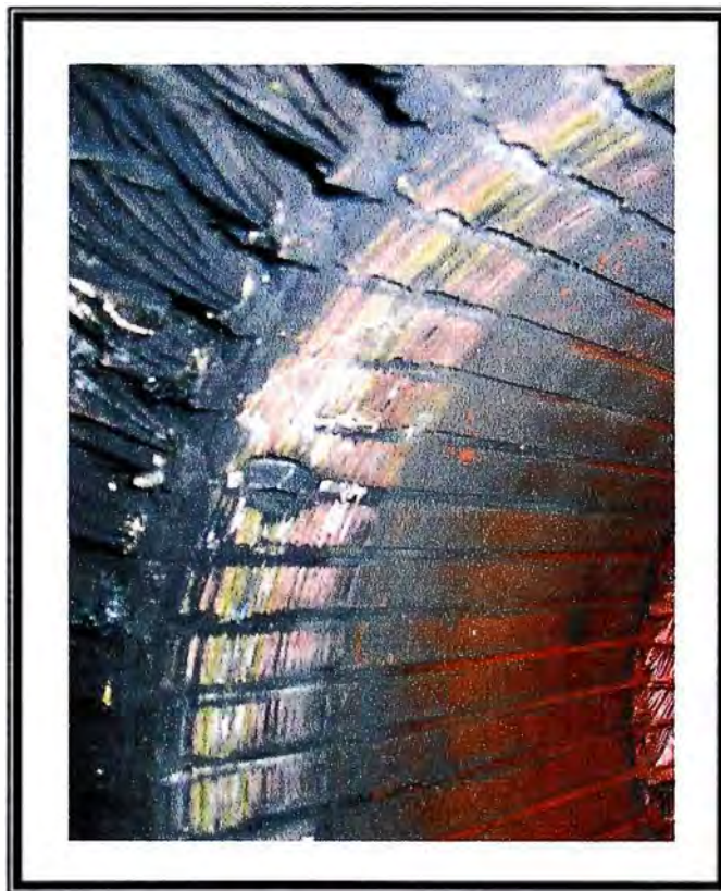
Figura 5.3 Cortocircuito en Láminas del Estator
