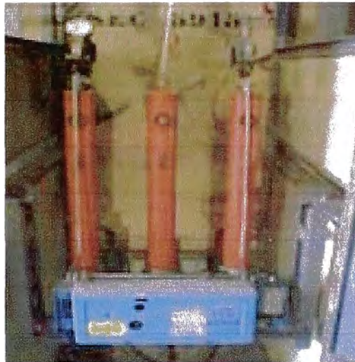
Fig. 3.2 Interruptor automático en 10 kV, tipo interior y tipo "pequeño volumen de aceite".
