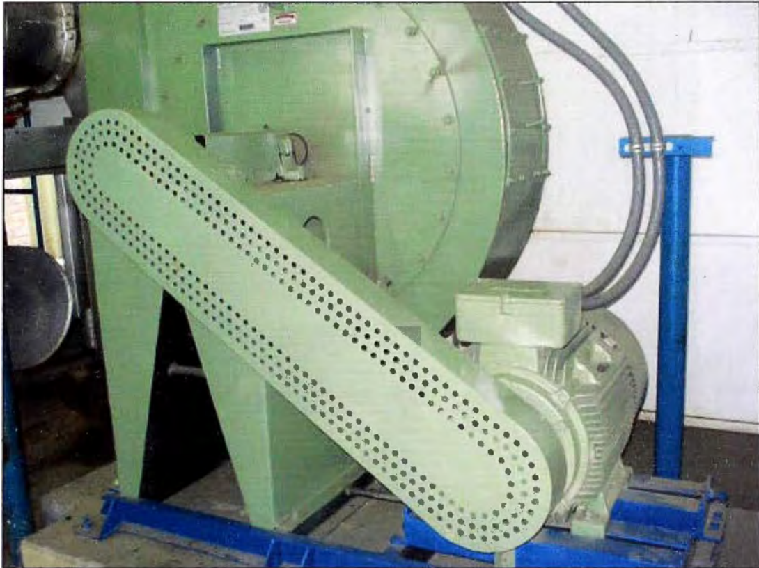
Figura 3.50 Ventilador del convertidor 12K1
