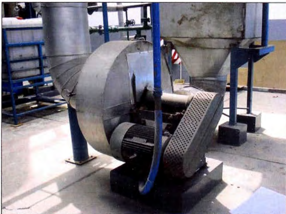
Figura 3.49 Motor del ventilador de Regeneración 11K2
