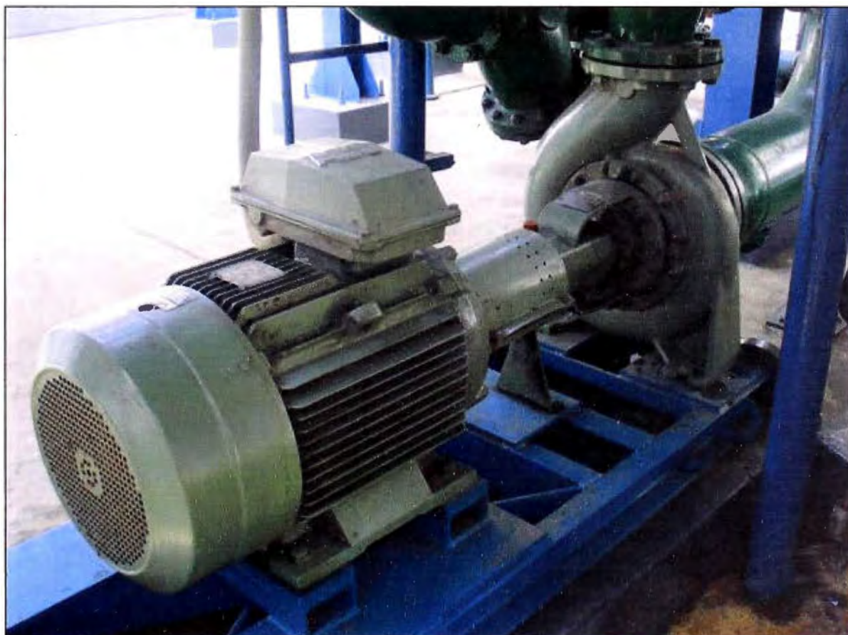
Figura 3.56 Bomba de agua del Reactor 16P1, Equipo 5048-5049
