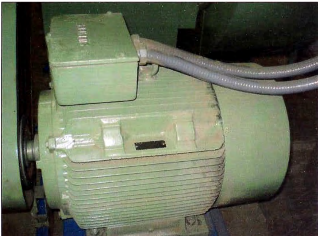
Figura 3.51 Motor del ventilador del convertidor 12K1
