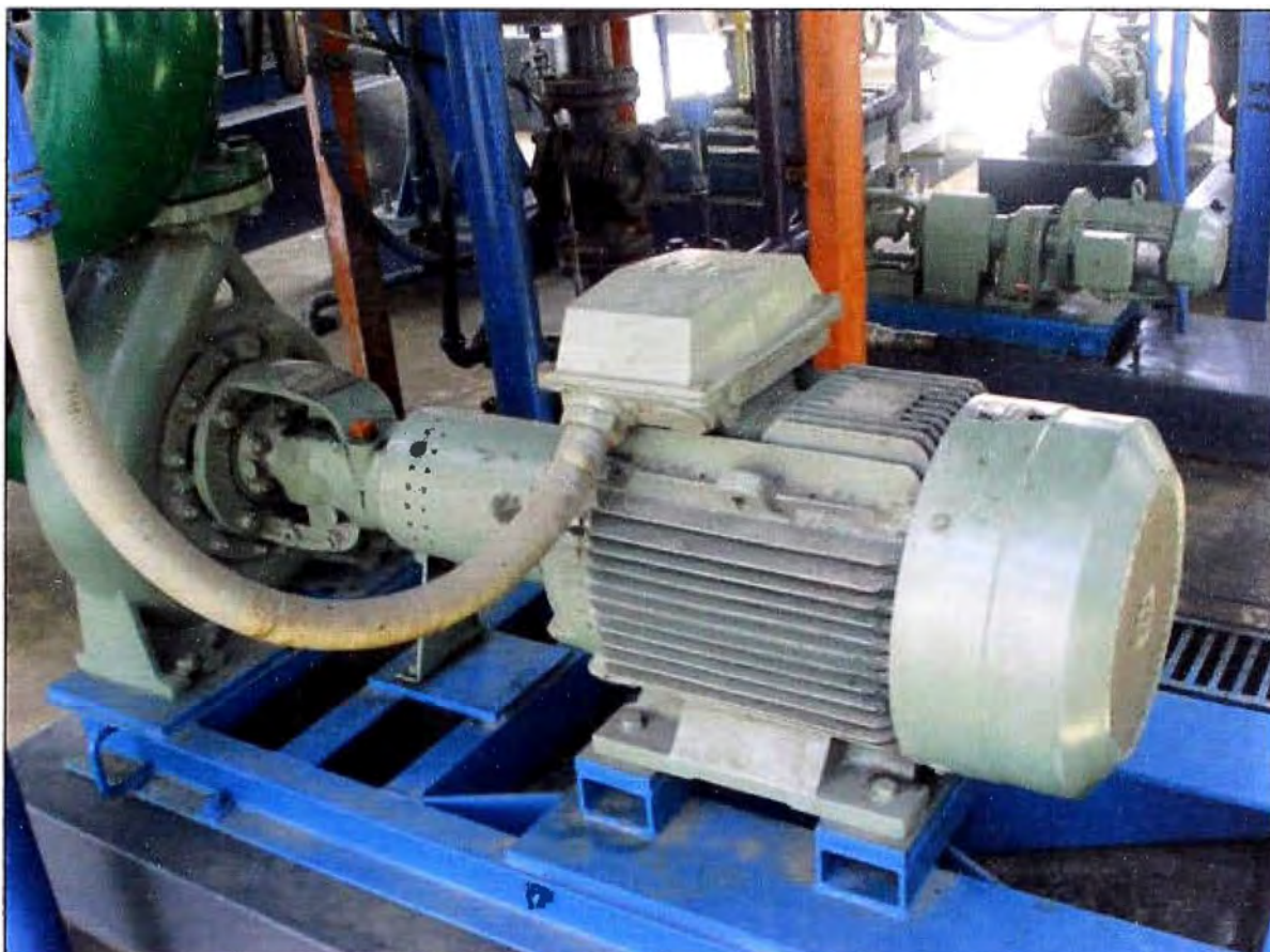
Figura 3.55 Bomba de agua del Reactor 16P1, Equipo 5048-5049
