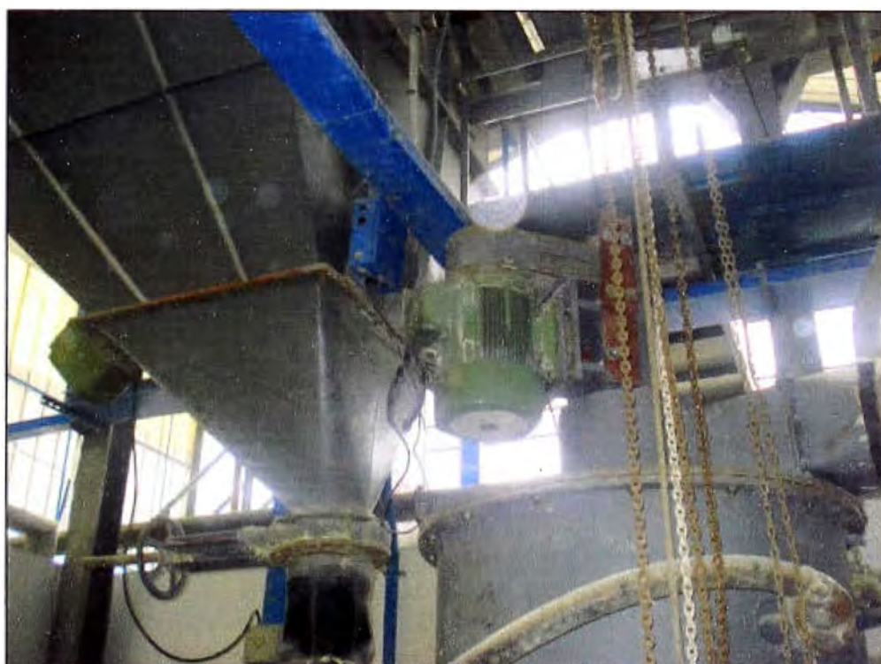
Figura 3.68 Motor del Ventilador de Sílica 12K1, Equipo 5057
