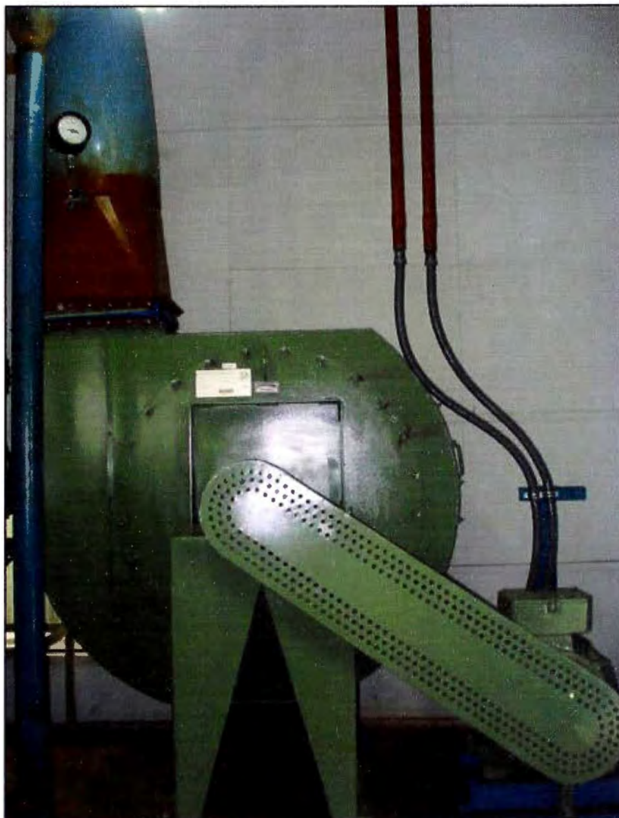
Figura 3.52 Ventilador del convertidor 12K1
