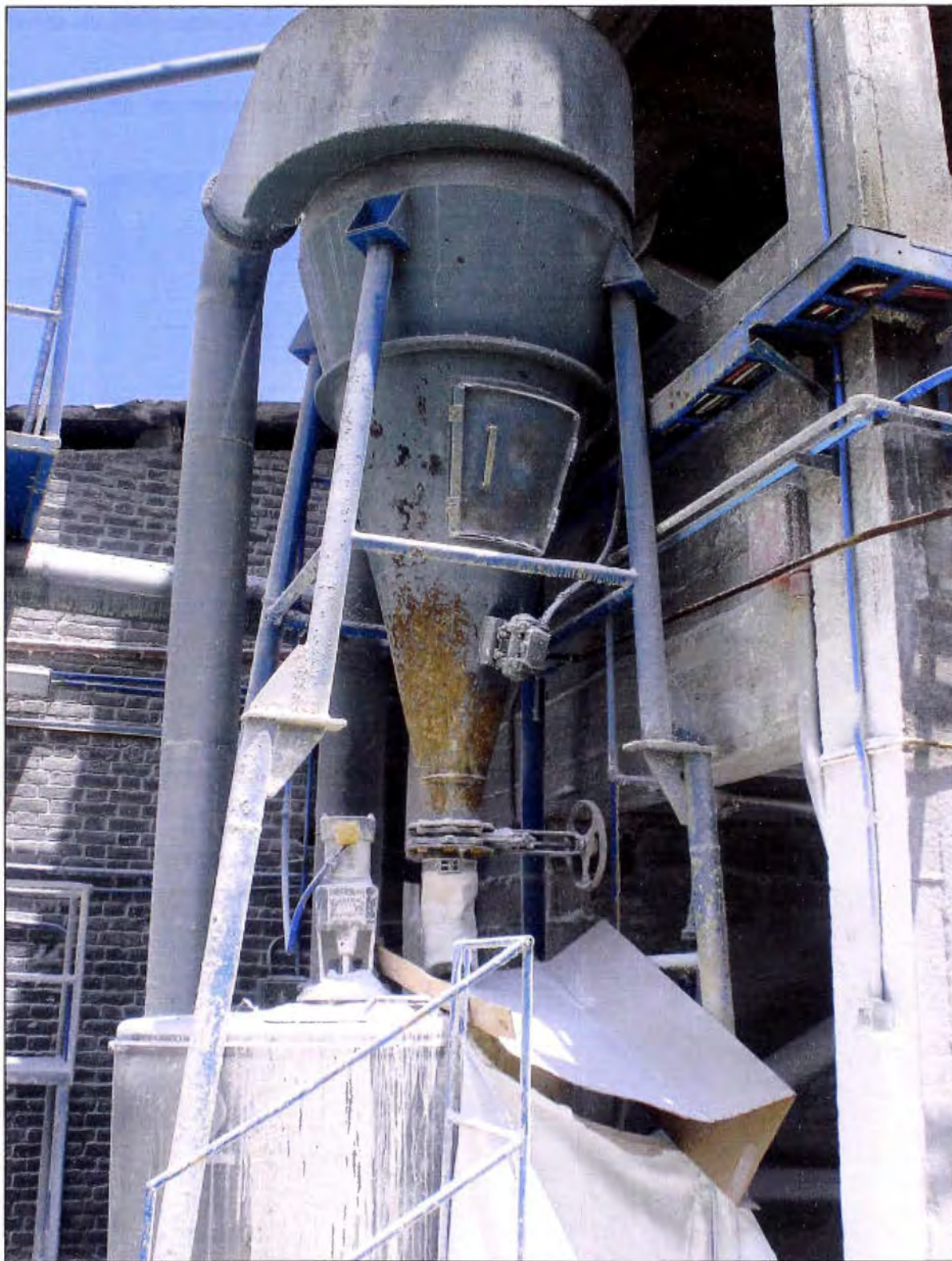
Figura 3.66 Tolva de recuperación de polvo, el Equipo 5060 está ubicado en el segundo nivel
