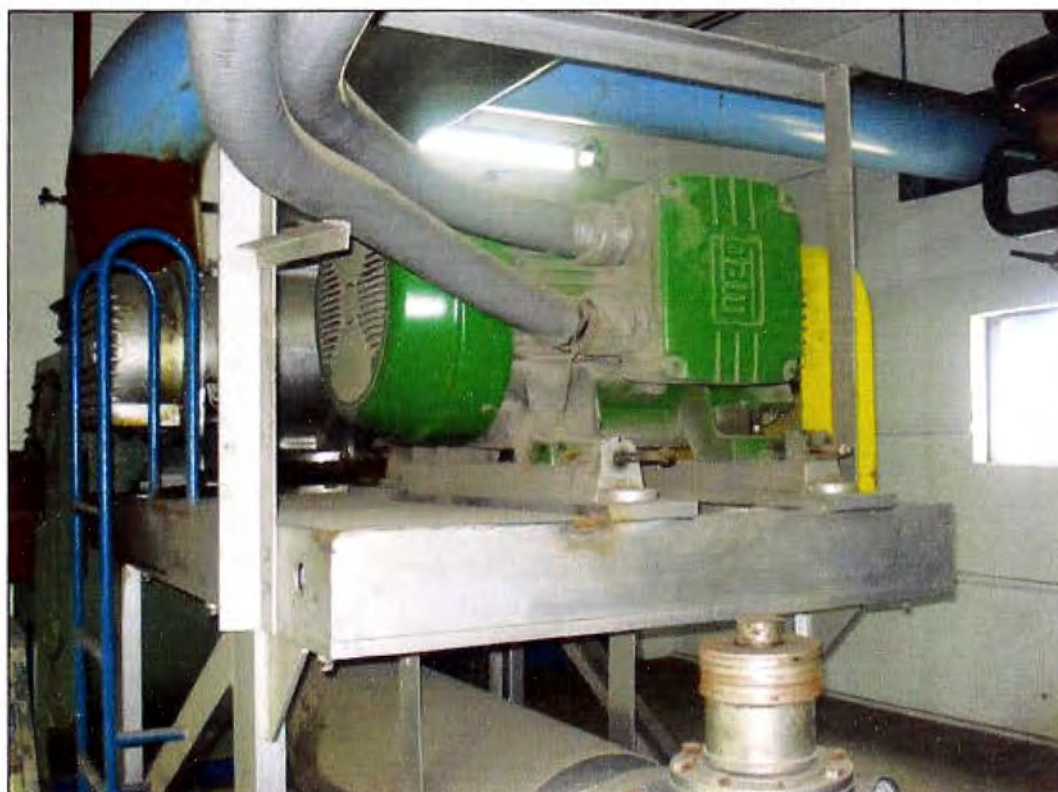
Figura 3.41 Motor del Compresor Omel, equipo 5041
