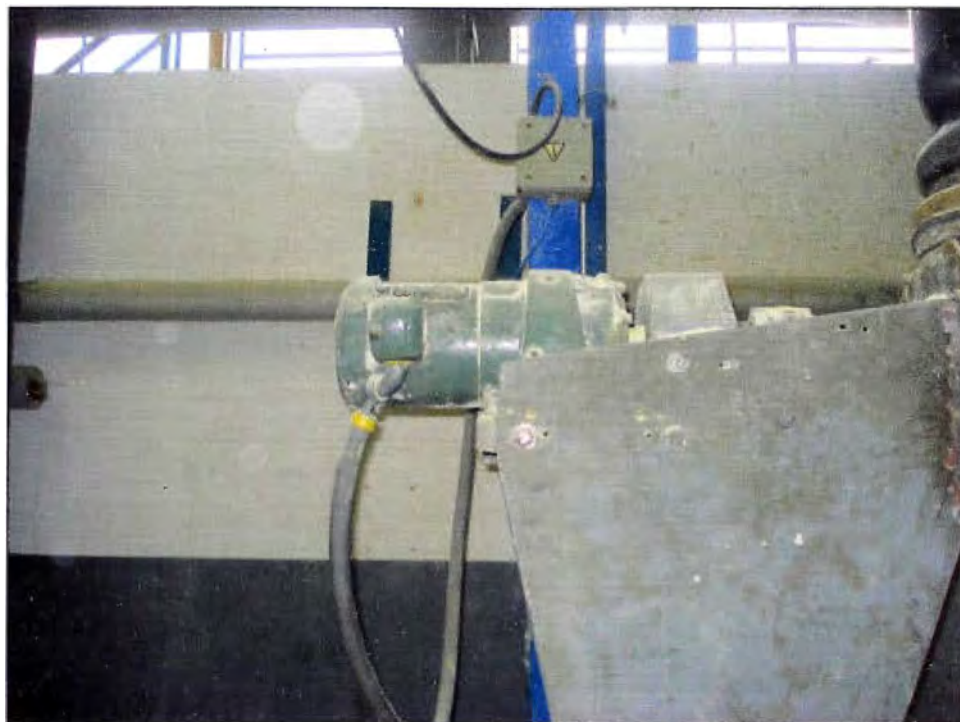
Figura 3.67 Motor del Ventilador de Sílica 11K2, Equipo 5056
