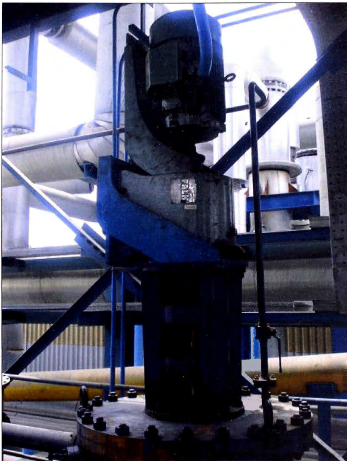
Figura 3.45 Motor de envejecimiento 16 A1, Equipo 5044 ubicado en el segundo nivel de la planta
