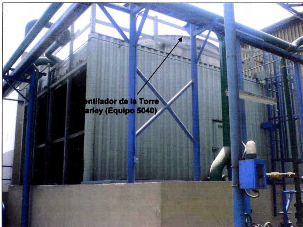
Figura 3.37 Ventilador de la Torre de enfriamiento Marley 1, el Equipo 5040 está ubicado en la parte superior de la torre.
