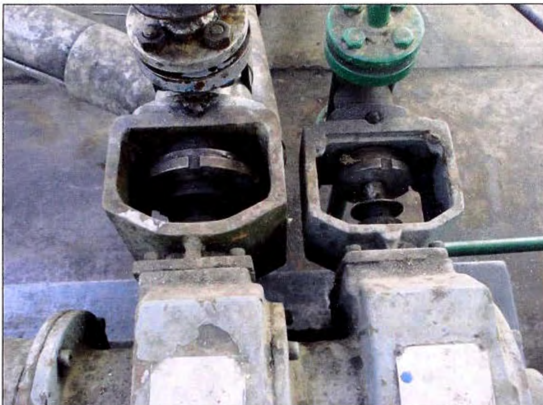
Figura 3.61 Bomba de agua de producción 16 A1, Equipo 5052-5053
