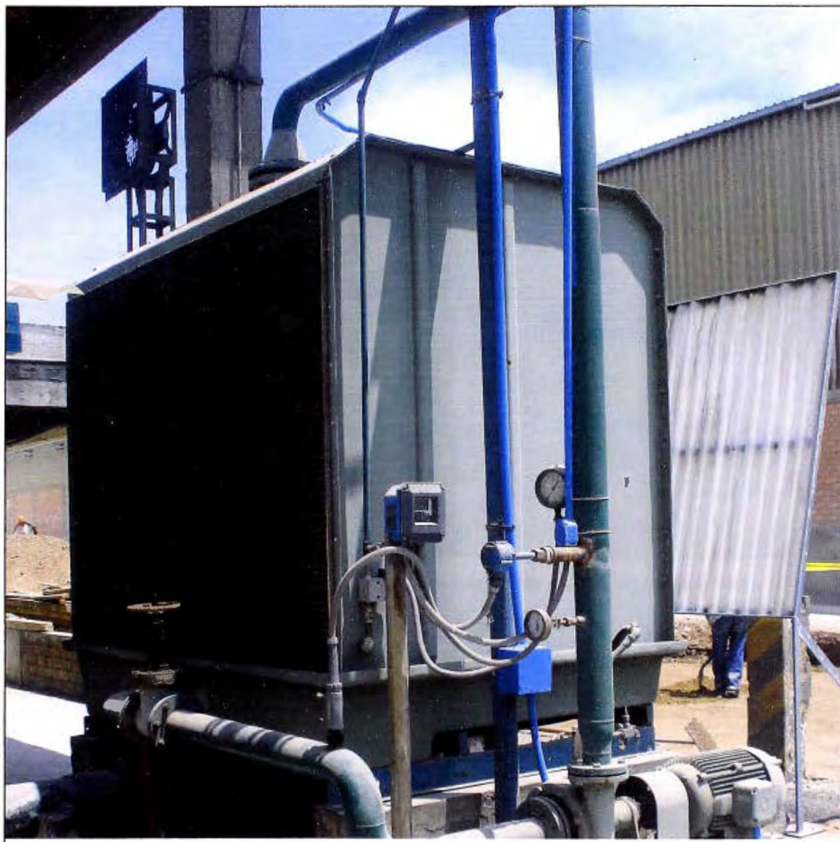
Figura 3.64 Torre de enfriamiento Marley 2, Equipo 5059
