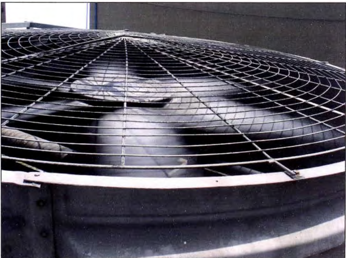
Figura 3.39 Ventilador de la Torre de enfriamiento Marley 1
