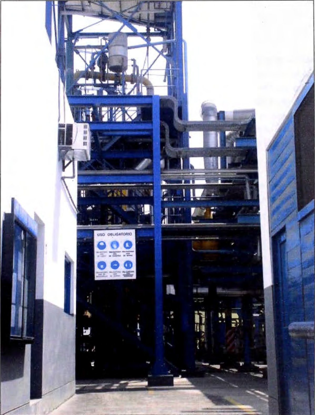
Figura 3.36 Entrada de la Planta de Acido Sulfónico
