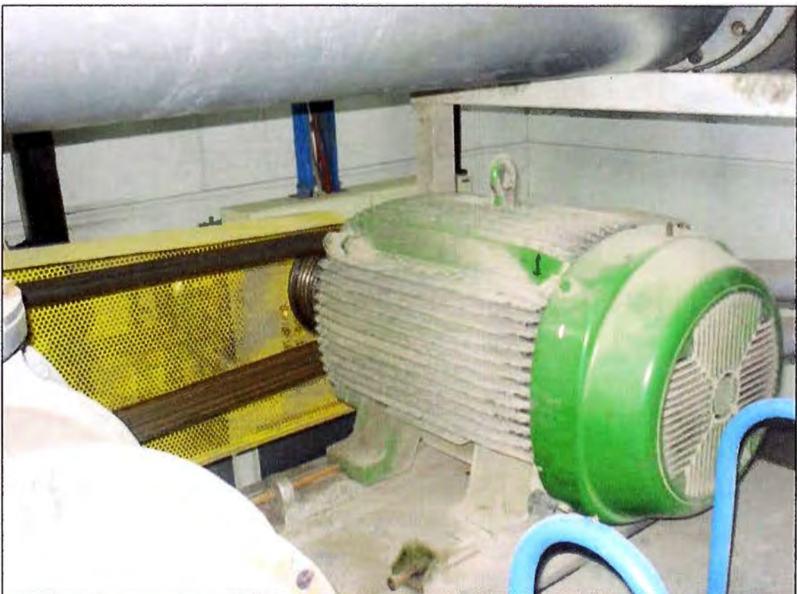
Figura 3.43 Guarda de faja y polea del Compresor Omel, equipos 5041-5042
