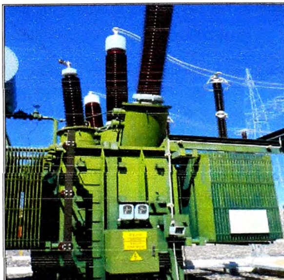
Figura 4.7 Reactor trifásico con núcleo de hierro, 50 MVar XL14 S. E. Cotaruse.
