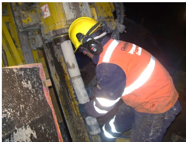
Figura 10: “Incidente con broca serrucho N° 1”
