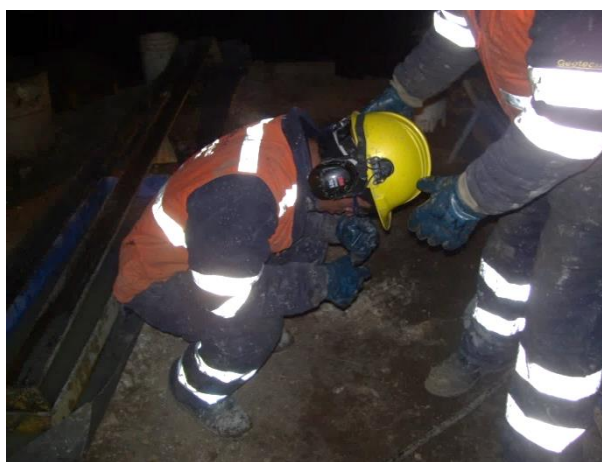
Figura 12: “Incidente con broca serrucho N° 3”
