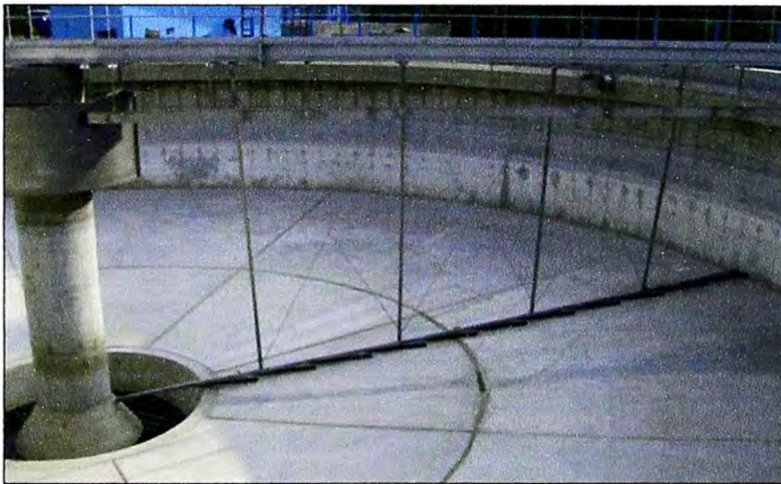
Figura 2.5 Sedimentador secundario (Fuente: Propia)
