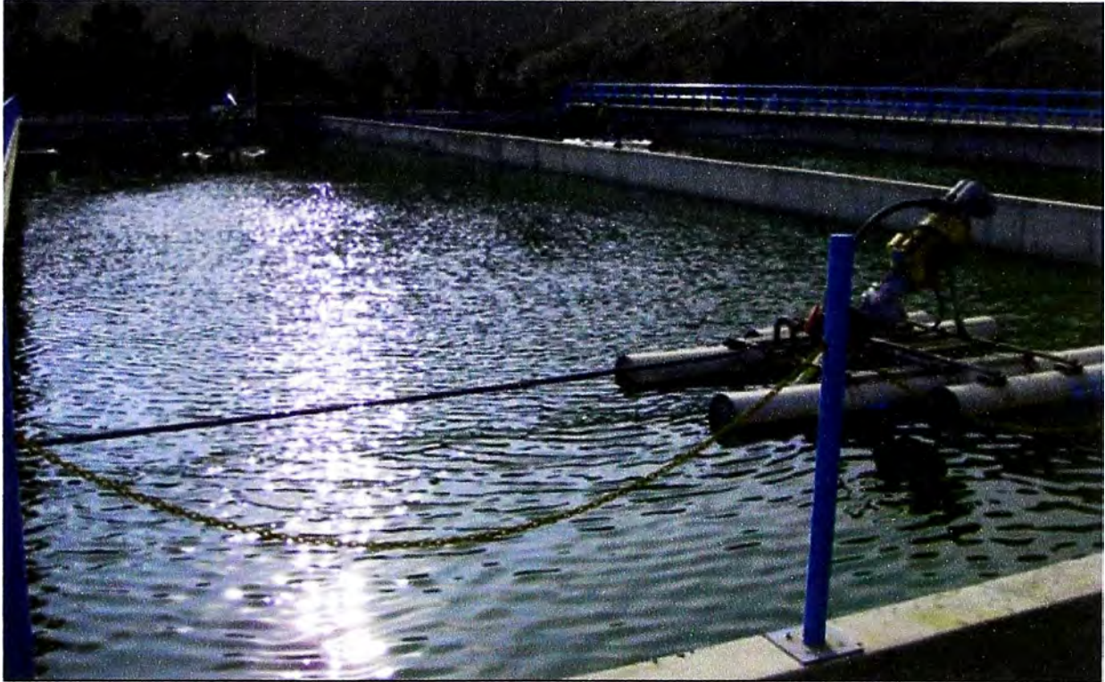
Figura 2.4 Reactor (laguna) de aireación prolongada (Fuente: Propia)
