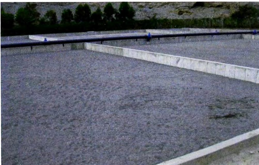
Figura 2.8 Lecho secado de lodo (Fuente: Propia)
