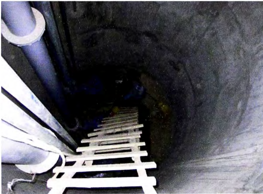
Figura 2.7 Espesador de lodos (Fuente: Propia)
