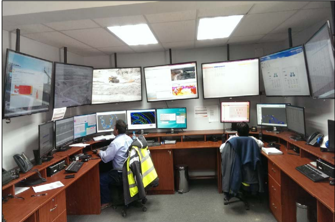
Figura 3.36 Sala de control Dispatch Antapaccay. Fuente: Foto sala de control Dispatch.
