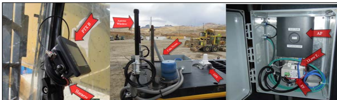
Figura 3.15 Hardware Dispatch en equipo auxiliar. Fuente: Instalación de hardware Dispatch Antapaccay.
