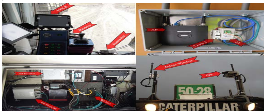
Figura 3.16 Hardware Dispatch en palas y cargadores. Fuente: Instalación de hardware Dispatch Antapaccay.
