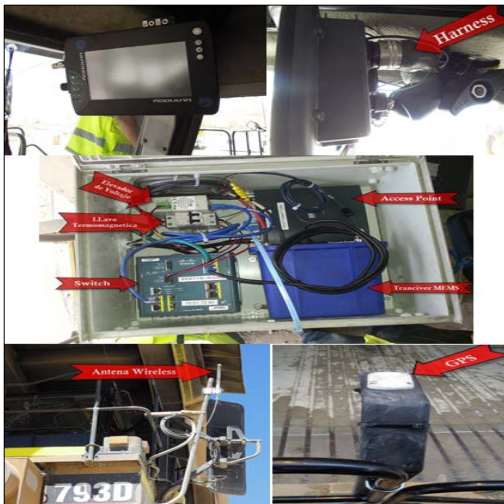
Figura 3.14 Hardware Dispatch en camiones. Fuente: Instalación de hardware Dispatch Antapaccay.
