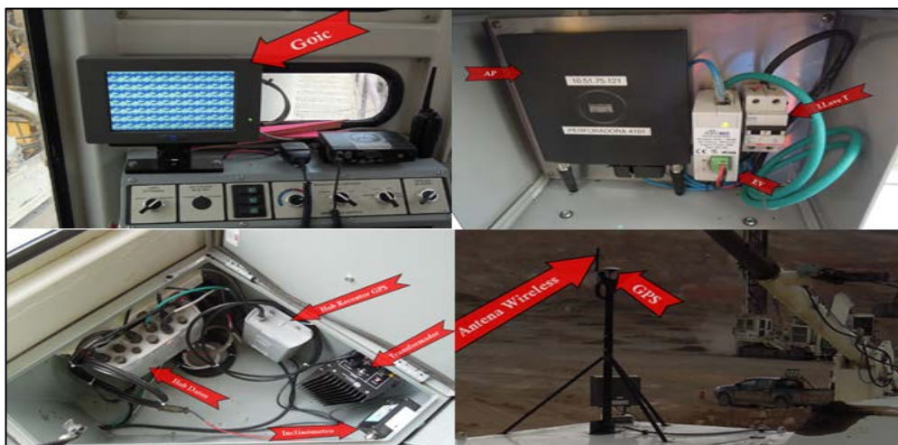
Figura 3.17 Hardware Dispatch en perforadoras. Fuente: Instalación de hardware Dispatch Antapaccay.
