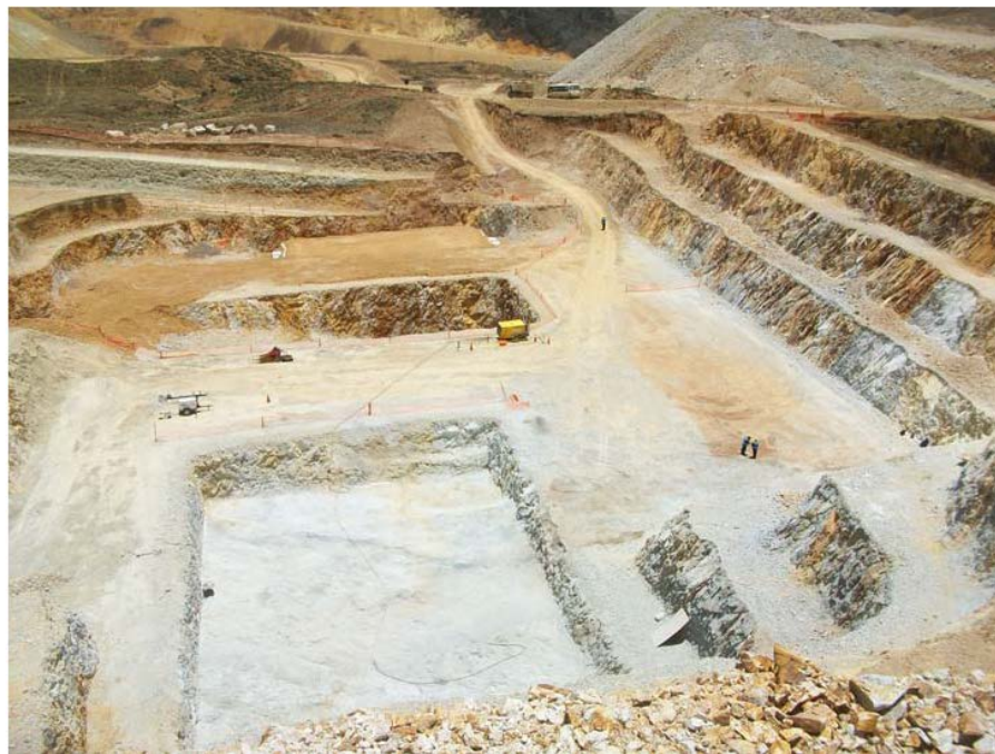
Figura 2.12 Vista general de la excavación, donde se observa los cortes de talud
