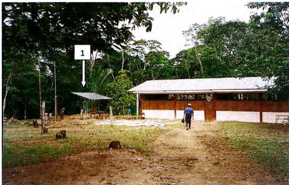
Foto D-1: YUTUPIS Internet Colegio: Paneles Solares (1)
