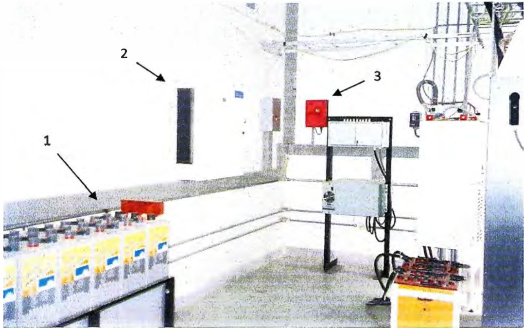
Foto B-3: ER RAMADA: 1 B. Baterías; 2 Controlador cerrado; 3 Inversor
