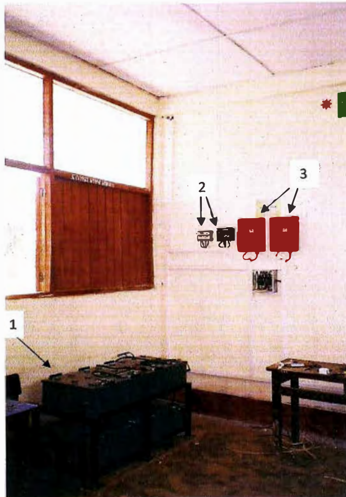
Foto D-4: YUTUPIS Internet Colegio: 1 B. Baterías; 2 Controladores; 3 Inversores
