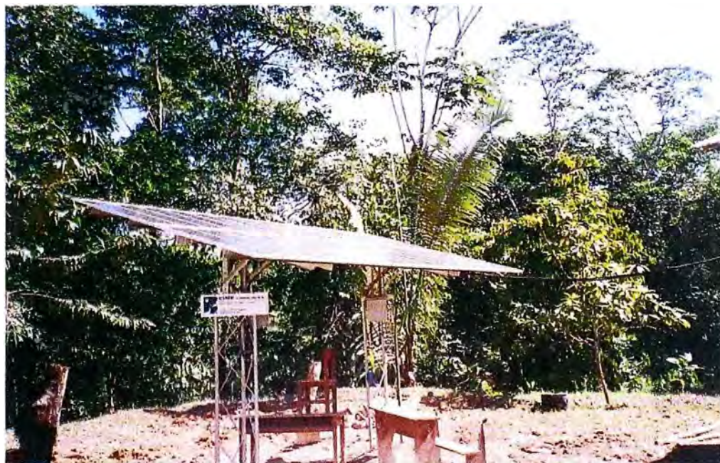
Foto D-2: YUTUPIS Internet Colegio: Paneles Solares
