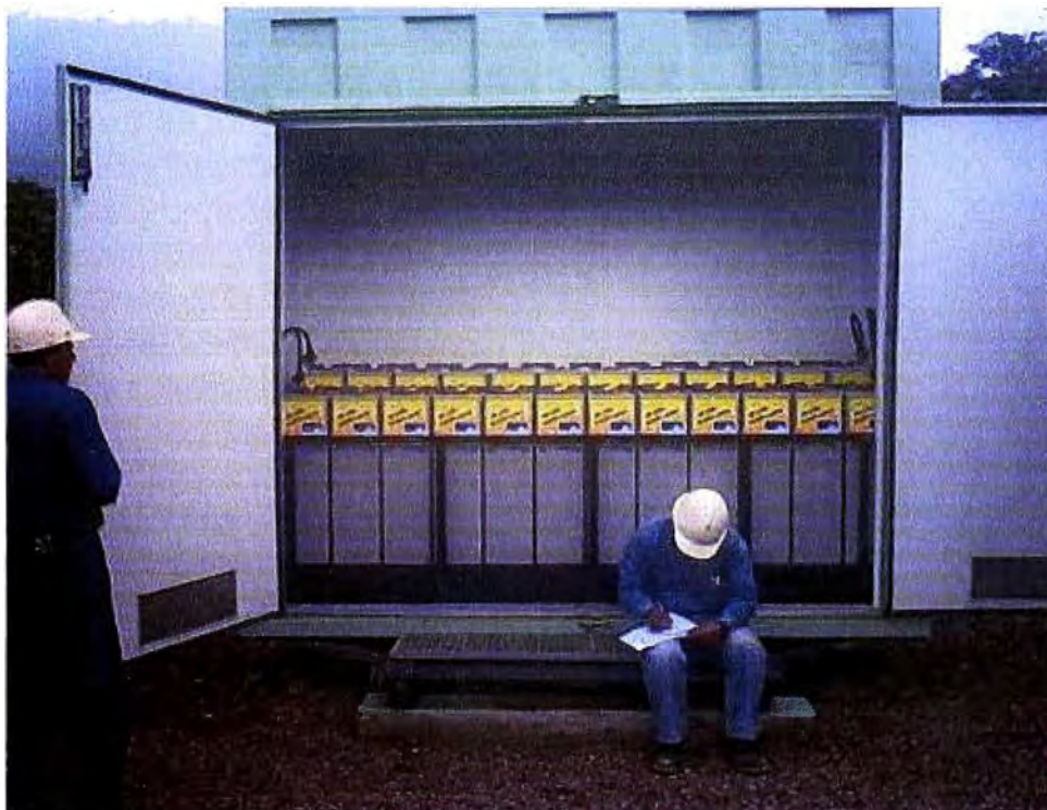
Foto C-2: OCP Ecuador: Banco de baterías en Shelter
