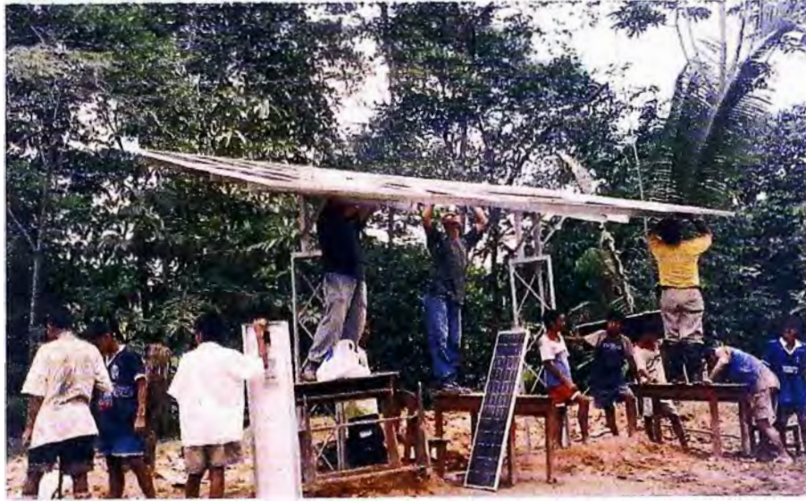
Foto D-3: YUTUPIS Internet Colegio: Paneles Solares
