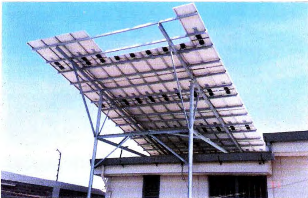
Foto B-2: ER SECHURA: Paneles Solares – Vista posterior
