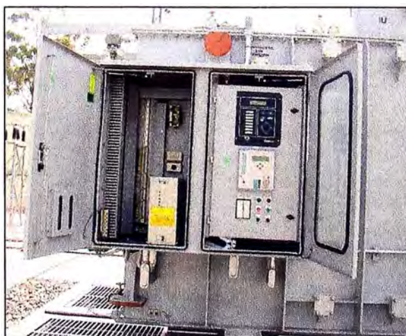
Figura 3.10 Tablero de ventiladores (Fuente: Registro Montaje de Transformador de Potencia – SIEMENS-Perú 2004)
