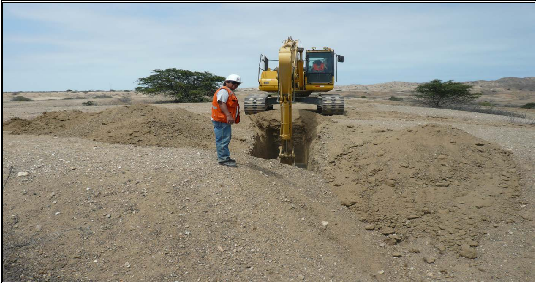
Foto N° 1.8 : Se aprecia a una excavadora en plena excavación de un pozo para cubicación de aluviales.
