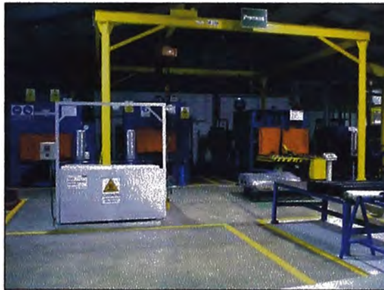
Figura N° 3.7. Prensas grandes del 1 a 4 neumáticas a vapor.
