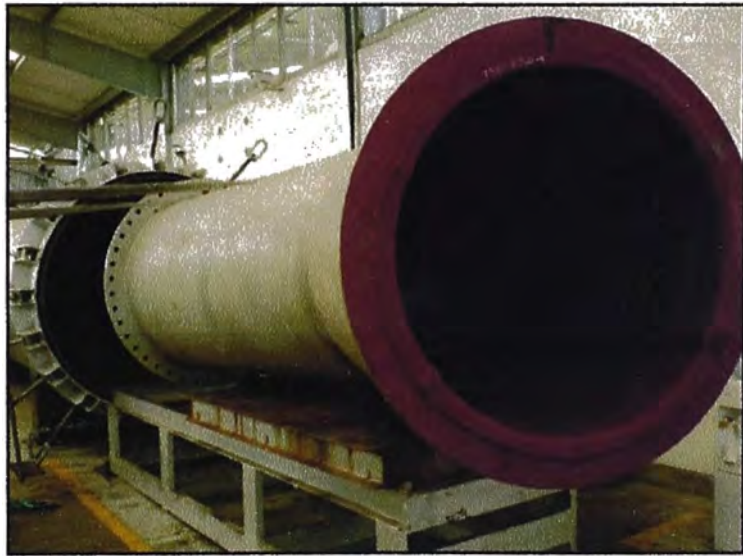
Figura N° 4.14. Tuberías matrices de pulpa minera.
