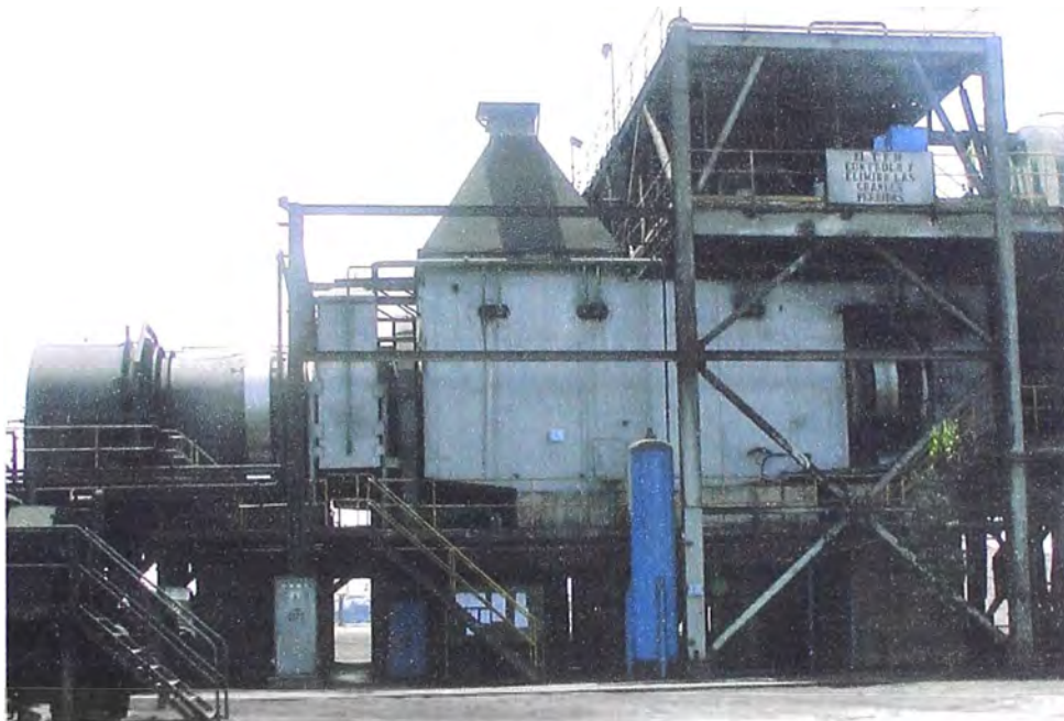
Figura 2.23: Enfriador del horno rotatorio
