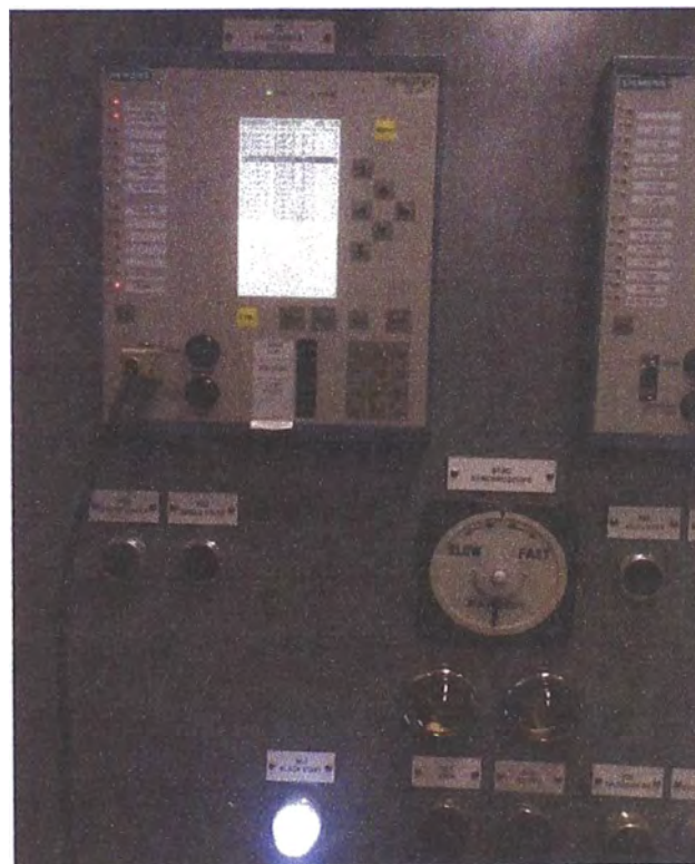
Fig. 3.21 Relé de sincronismo del generador
