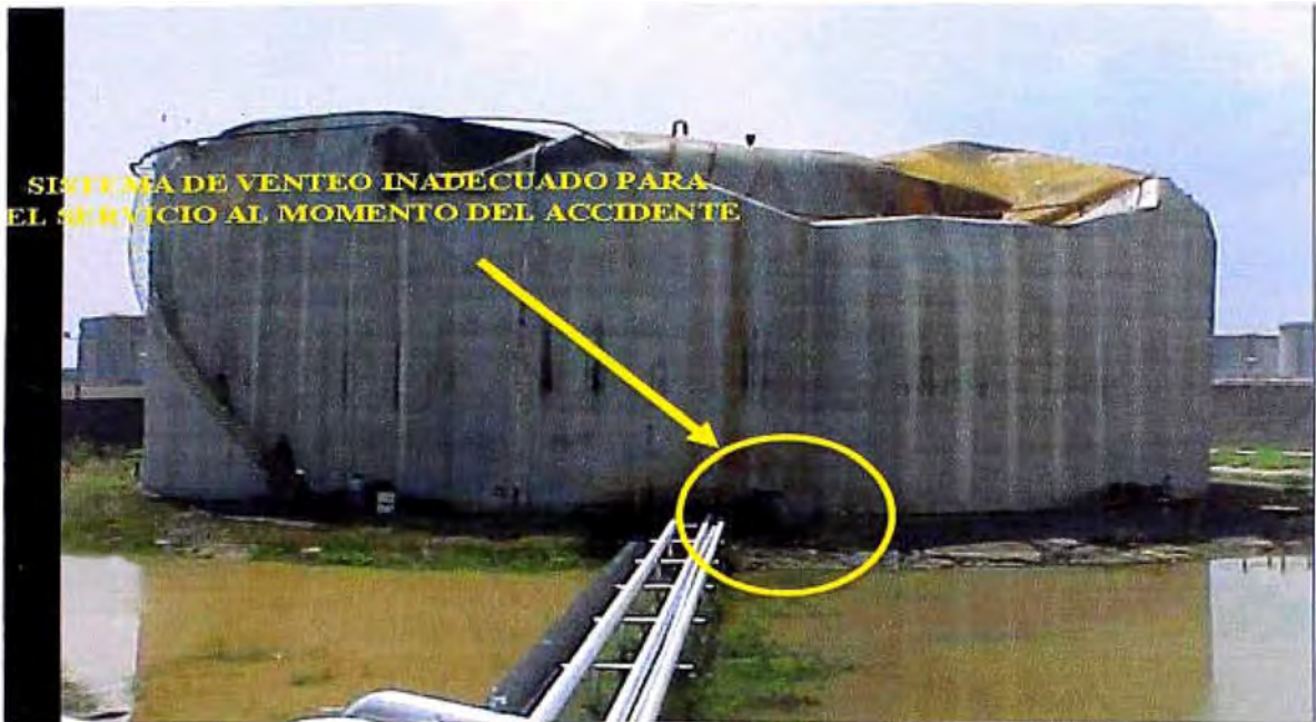
Figura N° III- 3: El sistema de venteo debe ser el adecuado para evitar accidente
