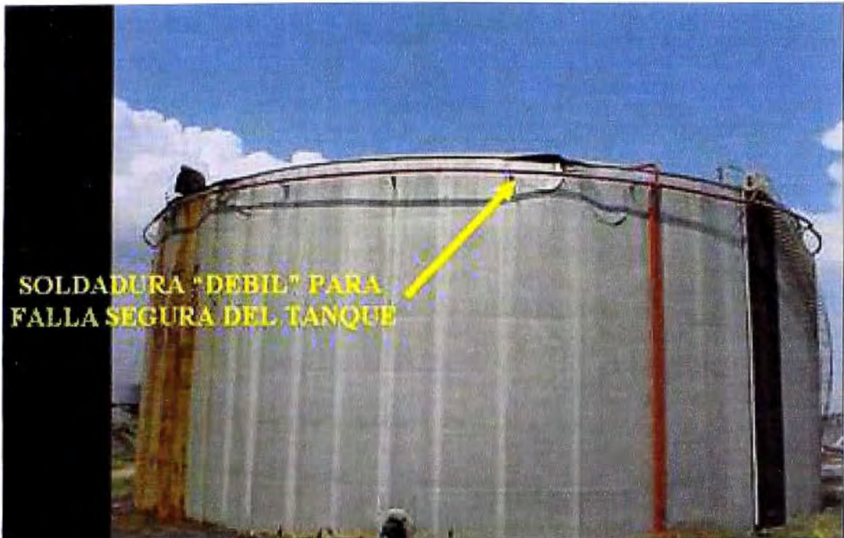
Figura N° III-4: Tipo de soldadura débil en un tanque
