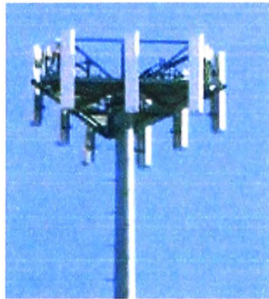
Fig 2.8 Típica torre de transmisión de telefonía celular
