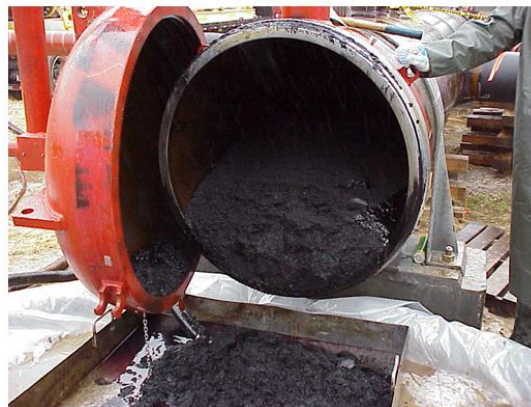
Fig.16 Ducto con presencia de Sulfuro de hierro ( \text{FeS} )
