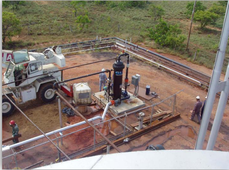
Fig 70. Reactor Gas / Líquido
