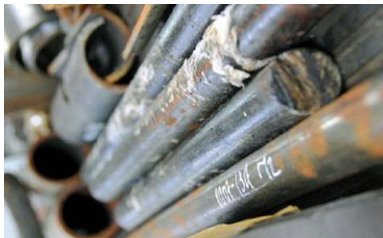
Fig. 15 Corrosión por Bacterias (MIC)
