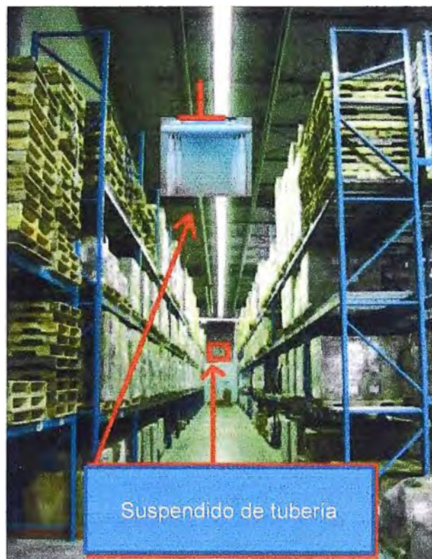
Figura 3.23 Instalación de los APs Indoor (Fuente [14])
