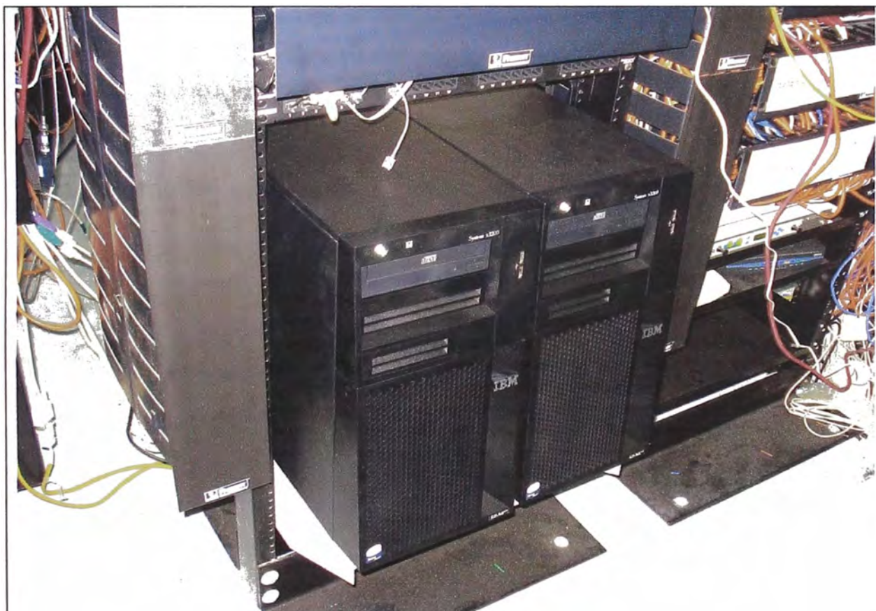
Ilustración 3.1 Servidores IBM X3200 de la Central Telefónica IP, Grupo Deltron
