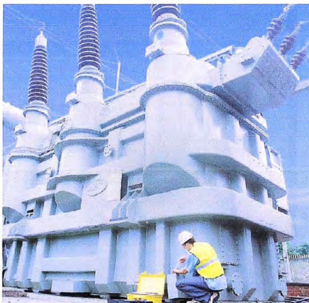
Fig. 5.4 – Foto del uso del equipo portátil de monitoreo de gases
