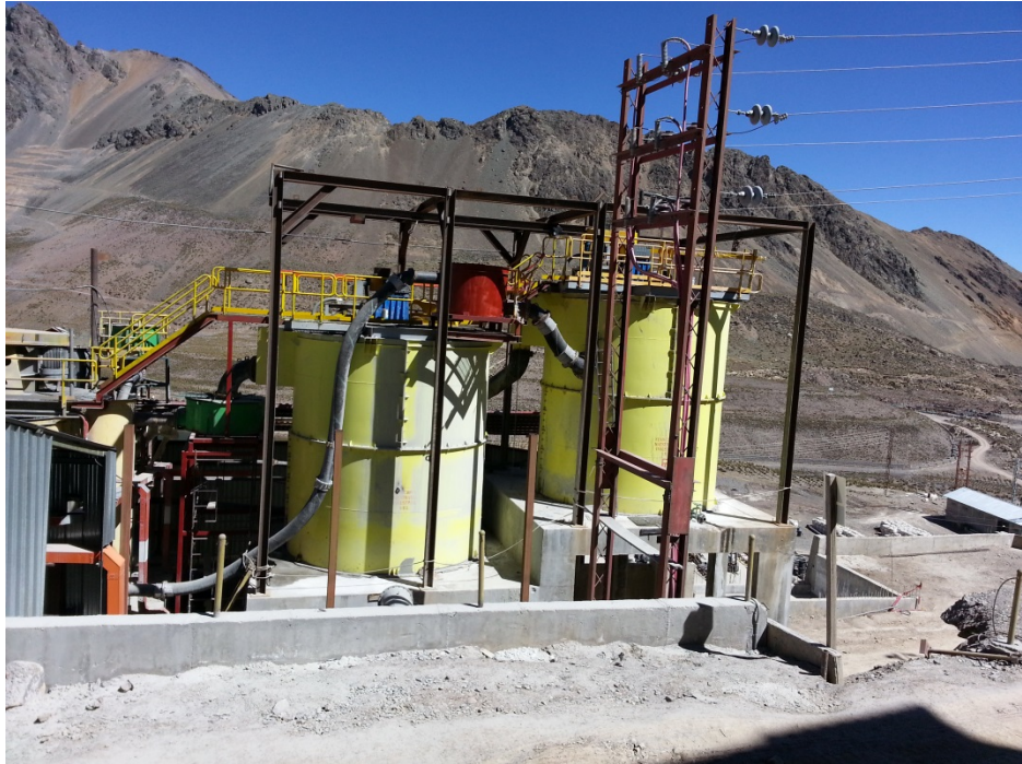
Figura 19: Vista de perfil de los Acondicionadores en serie
