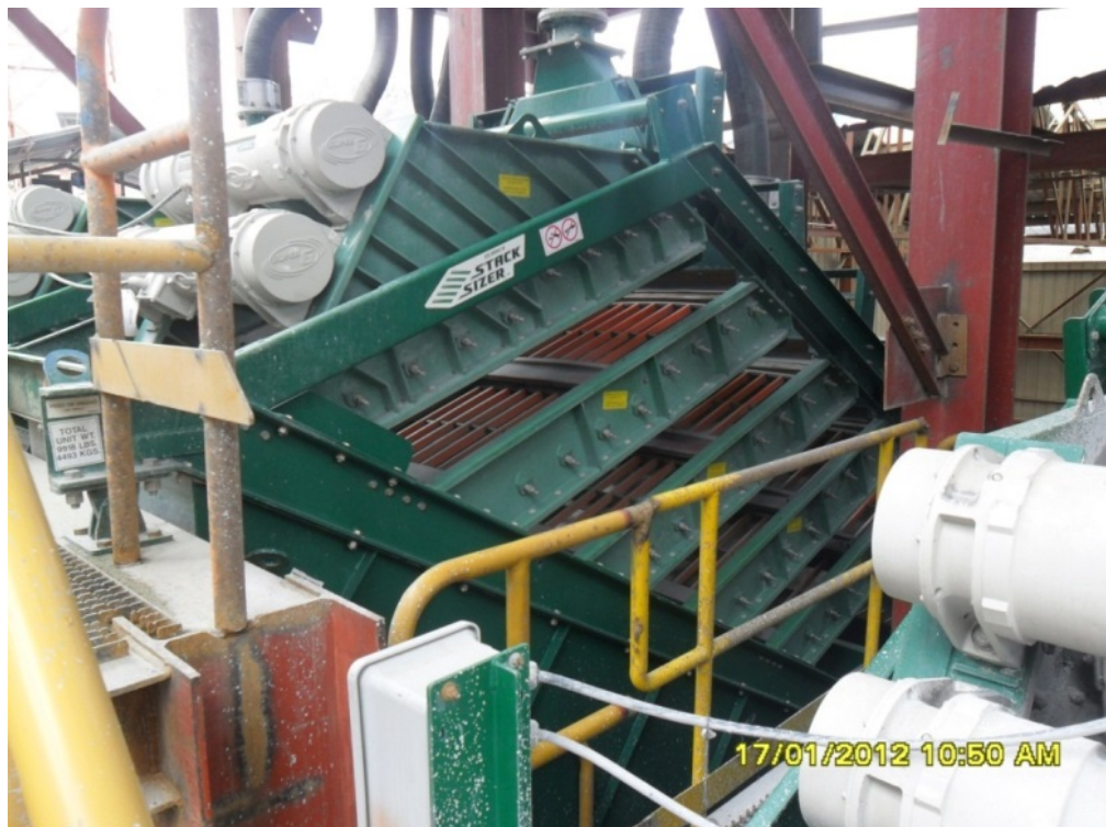
Figura 15: Zaranda de alta frecuencia, vista de perfil (Observe los 05 pisos)
