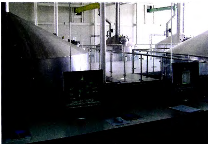
Fig. 3.2 Sala de Cocimiento.
