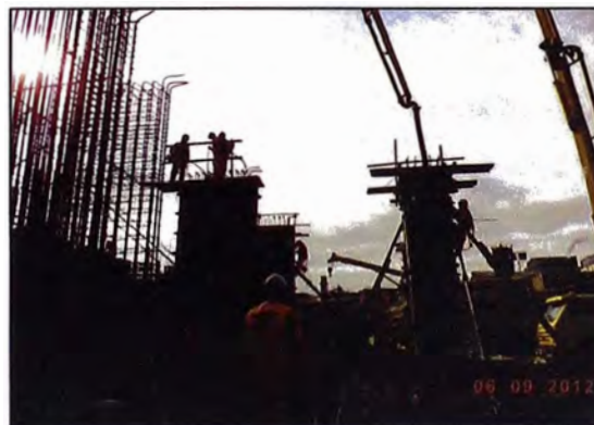
Figura N° 1.7.- Ausencia de cuadrilla de vaciado
