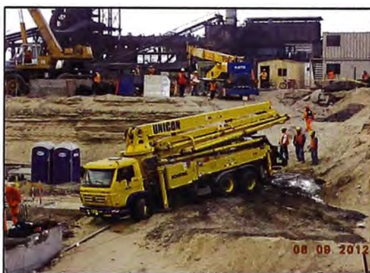
Figura N° 4.1.- Demora en instalación de bomba.
