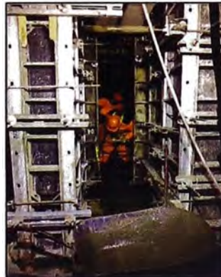
Figura N° 1.5.- Paralización de vaciado por fuga de concreto
