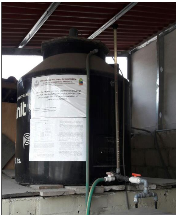
Figura 10.1. Tanque de almacenamiento y piezómetro, tanque eternit de 600 L con las válvulas de control, de descarga y distribución al sistema, acopladas en la parte inferior.
