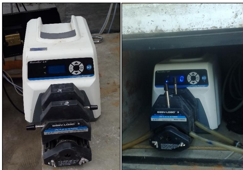
Figura 10.5. Bomba peristáltica Cole-Parmer con dos cabezales para mangueras masterflex de Ø 3/8 pulg. La imagen de la derecha muestra su ubicación en la caja de concreto.
