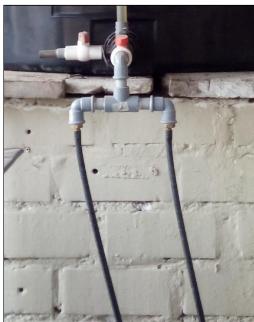
Figura 10.4. Mangueras siliconadas de Ø 3/8 pulg. forradas con cinta aislante negra para evitar el desarrollo de algas en su pared interna. Va hacia la bomba peristáltica.
