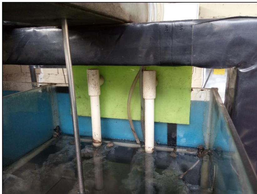
Figura 10.7. Tuberías de CPVC de \varnothing 1/2 pulg. y 42 cm de longitud, de ingreso sumergido.
