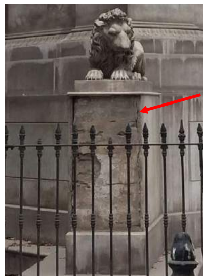
Placas de mármol faltantes por posible robo
