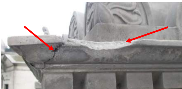
Grietas y faltantes
