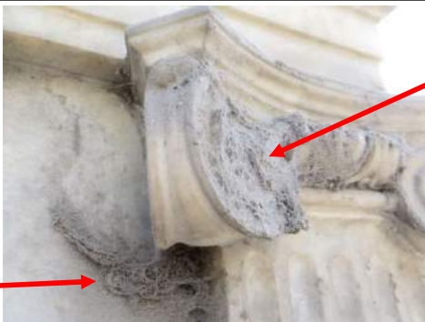
Acumulación de polvo, suciedad y telas de araña
