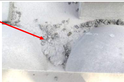
Acumulación de polvo y suciedad
