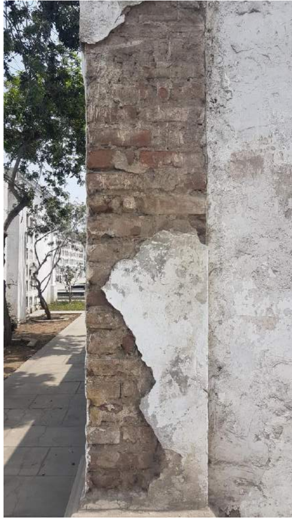
Figura 56. Detalle de columna de un muro de departamentos de nichos donde el material de recubrimiento ha caído. Foto: Alexandra Gambetta, 2019.
