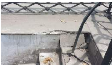
Detalle de roturas en las placas de mármol de la escalera a la cripta
