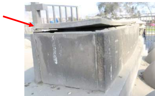
Deformación de placa de mármol (alabeo)
