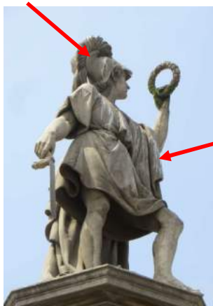
Acumulación de polvo, suciedad y excretas de aves
