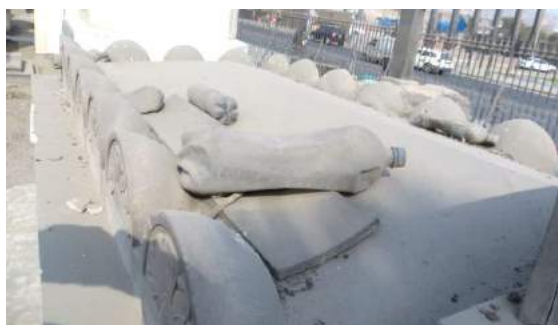
Acumulación de basura en el techo
