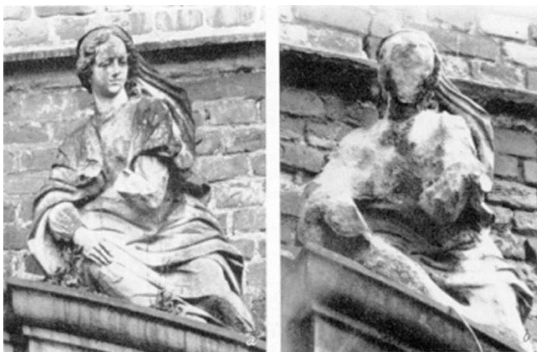
Figura 73. Deterioro de una escultura del Castillo de Herten, Recklinghausen, localizado en la cuenca del Rhin (Alemania) construido en 1702. A la Izquierda, una fotografía de 1908. A la derecha, una fotografía de 1969. Fuente: Delgado del Valle, 2014.
