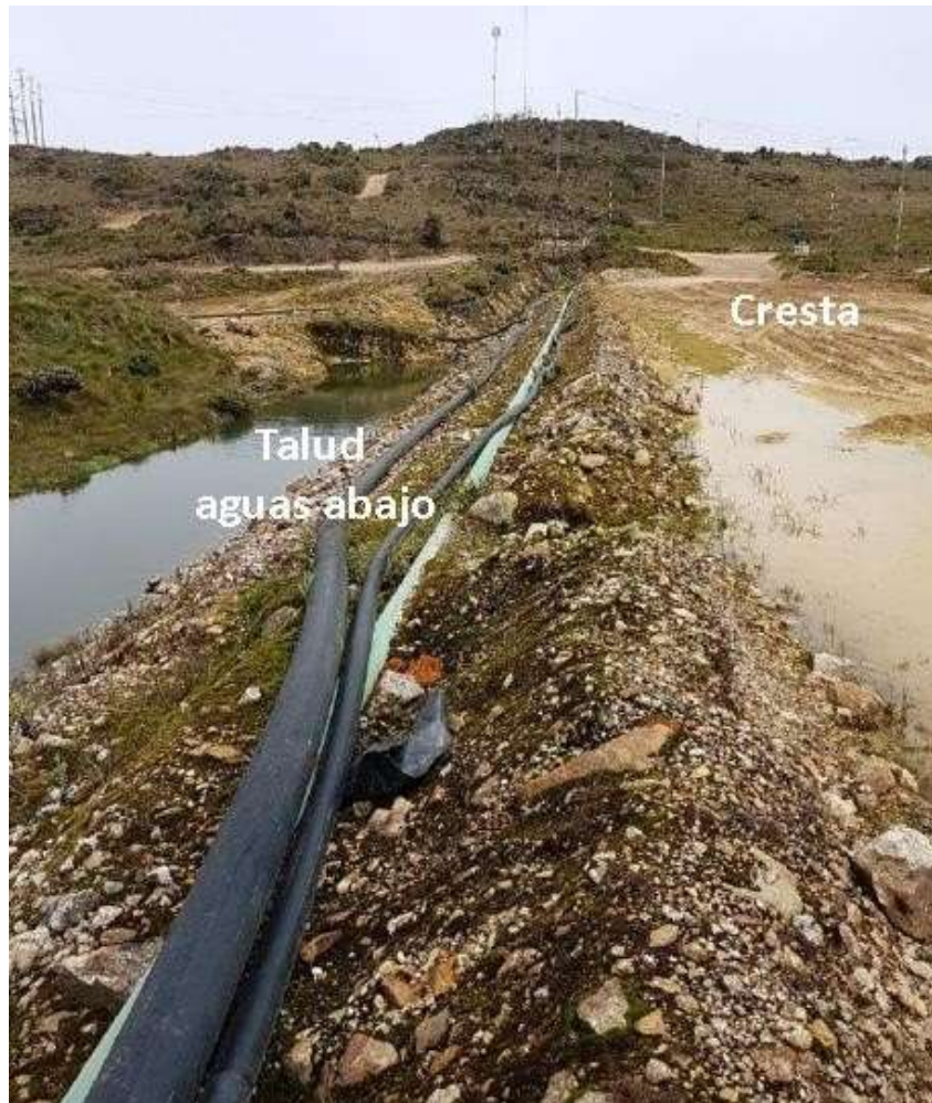
Ilustración 6: Vista de la acumulación de agua en la cara aguas abajo de la presa lateral
