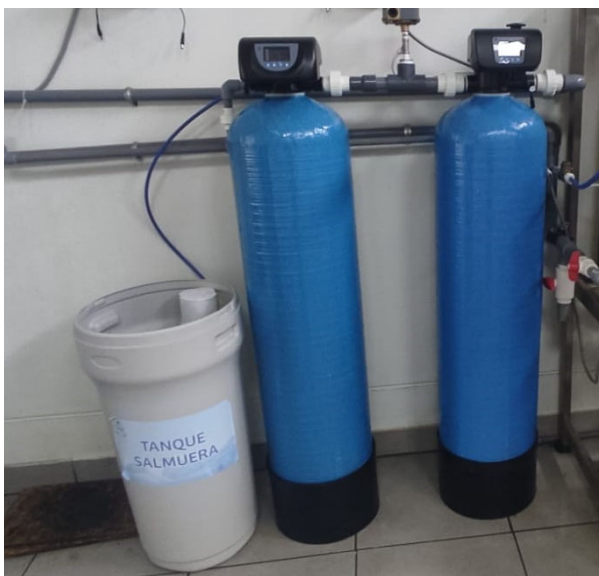
Ablandadores de agua- dúplex alternado
