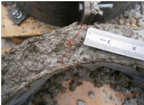
FOTO 6.3 Fisura en estado plástico
