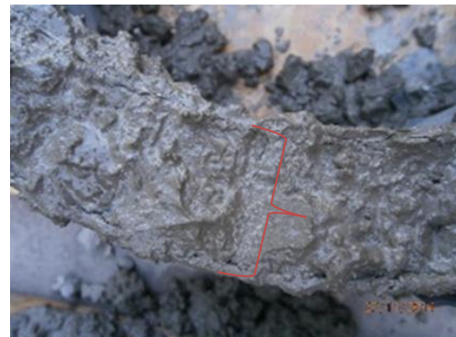
FOTO 6.6 Fisura en formación
