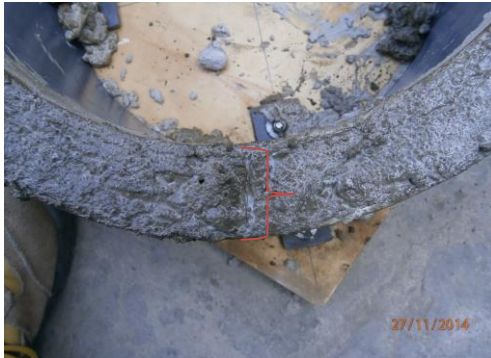
FOTO 6.1 Fisura en estado plástico
