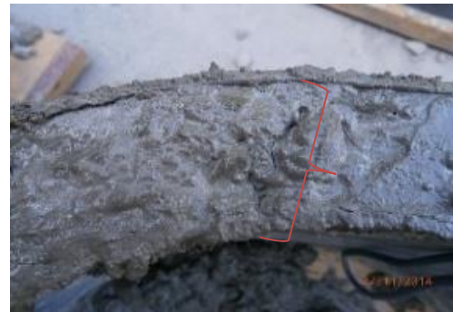
FOTO 6.4 Fisura en estado plástico
