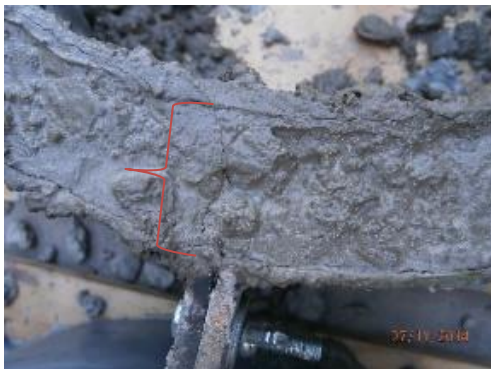
FOTO 6.5 Fisura en estado plástico
