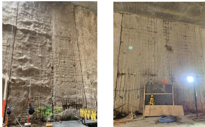
Figura N°4.46 Muros diafragma contaminados.
