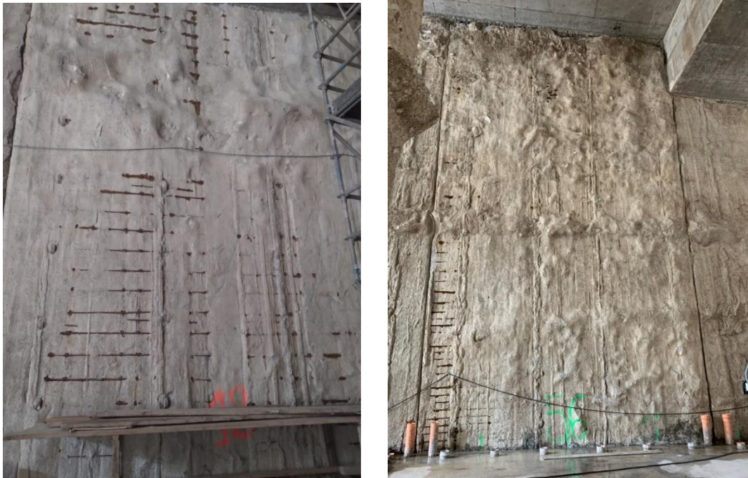
Figura N°4.47 Acero expuesto en el muro diafragma.
