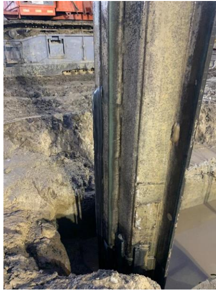
Figura N°4.45 WaterStop desprendido del muro diafragma sale en conjunto con la junta trapezoidal.
