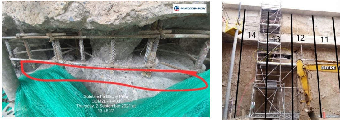
Figura N°4.48 Acero expuesto en el muro diafragma.
