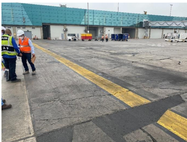
Pavimento de concreto deteriorado
