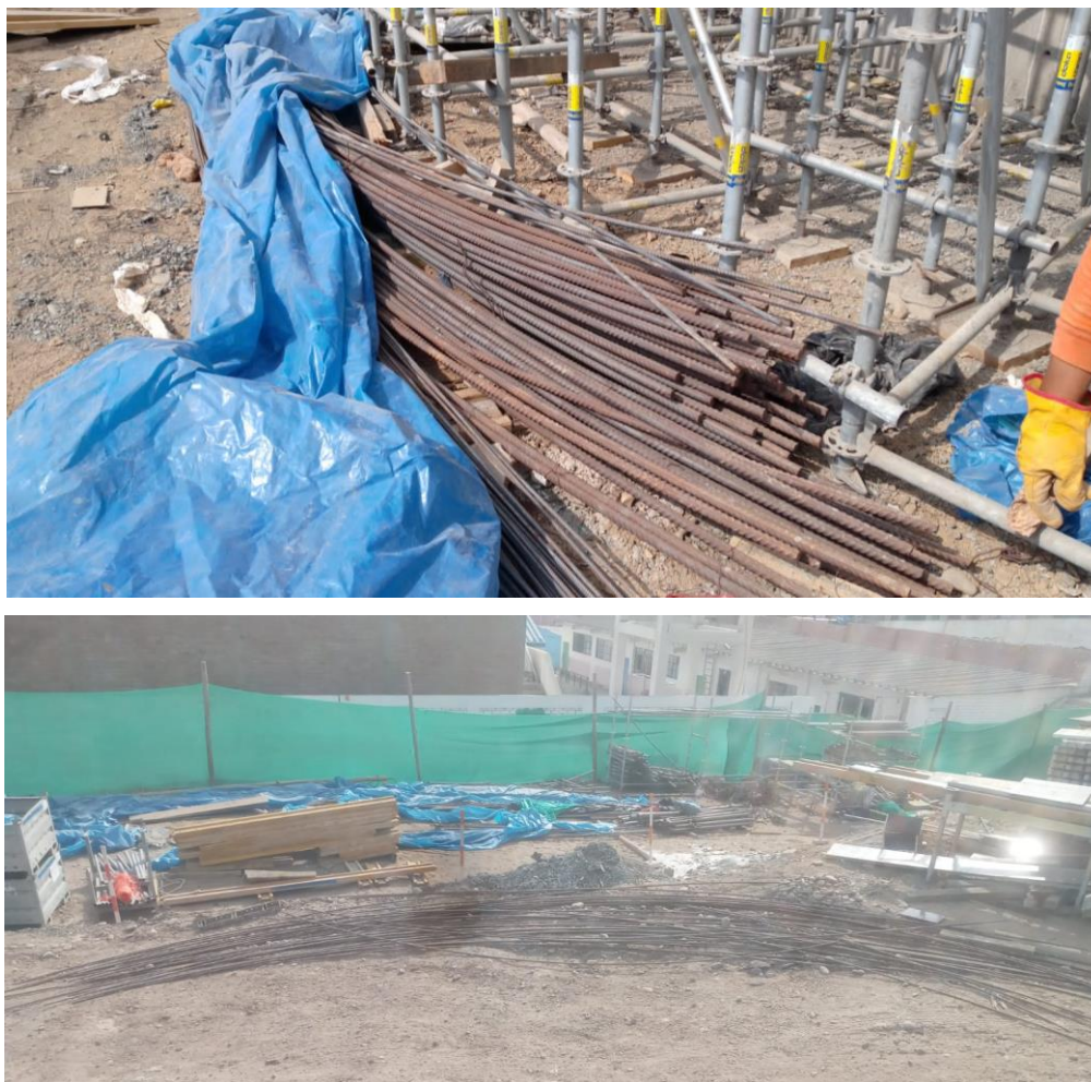
Figura N°3.12: Desperdicio de acero rolado de 3/4" para encofrado, no puede ser reutilizado por su curvatura.
