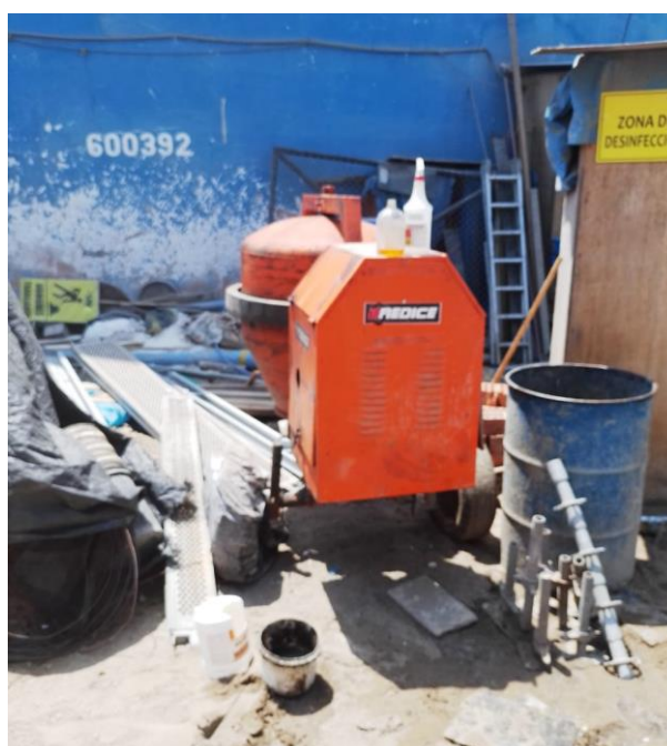
Figura N°3.11: Desorden en la zona de acopio, mezcla de equipos y materiales.
