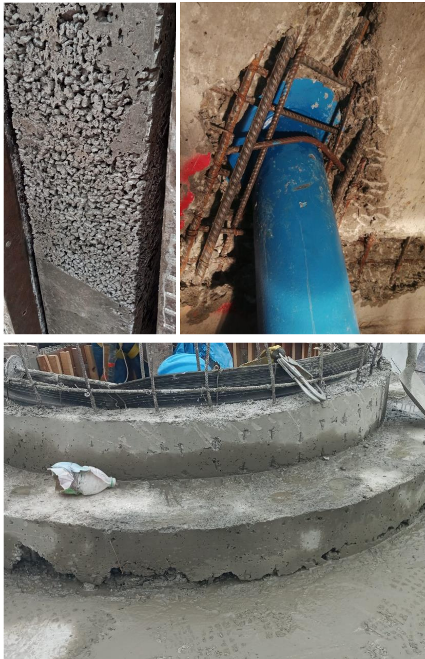
Figura N°3.9: Retrabajos asociados a costos de no calidad, por errores cometidos en vaciados de muro fuste, fondo esférico y anillo de muro cilíndrico interior, respectivamente.
