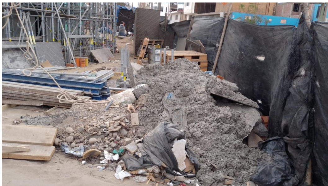
Figura N°3.13: Desperdicio de concreto de vaciado de muro cuba.
