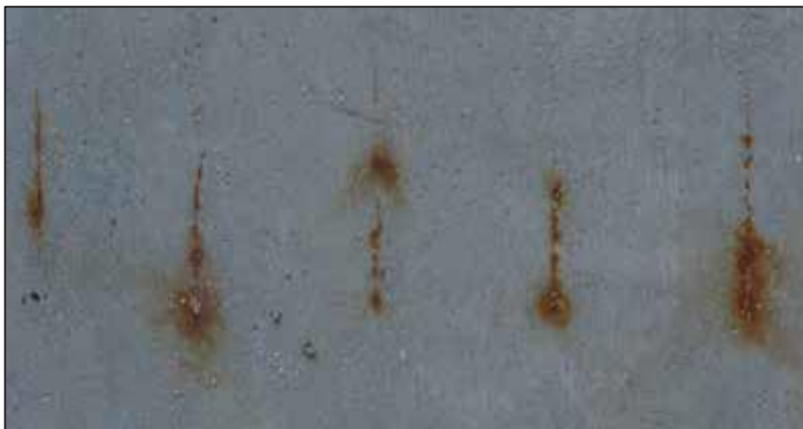
Figura N° 1: Manchas de óxido a lo largo de las varillas de refuerzo en una estructura de concreto armado. Fuente: Duffó y Farina (2019)
