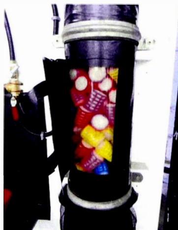
Fotografía N° 5 Instalación de Esponjas contenidas en portador dentro del reactor DHS-3G
