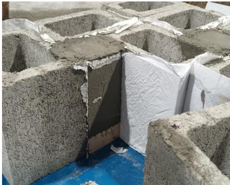
Figura N° 62: Desmolde de testigo de grout evidencia de humedad en los bloques (Nota: Fotografía propia)
