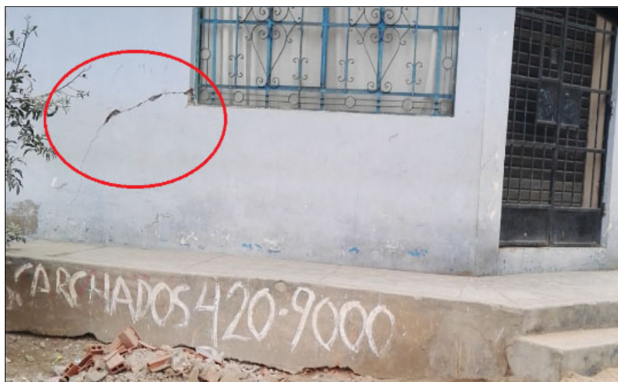
Figura N°97. Vivienda en Zona V con daño estructural
