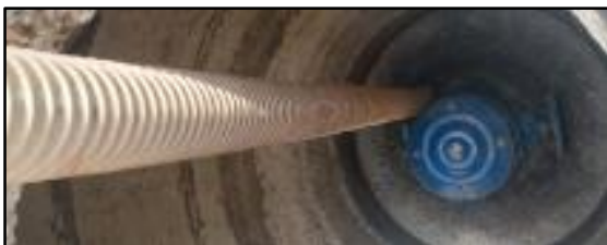
Foto 01: Válvula de aire N°23
