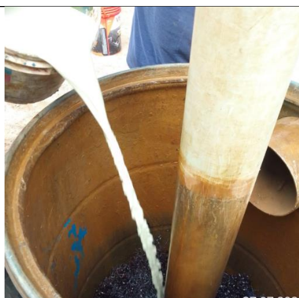
Fig. 04. Suministro de sulfato ferroso.
