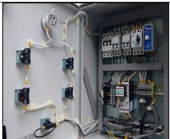
Fig.04: Tablero de mando
