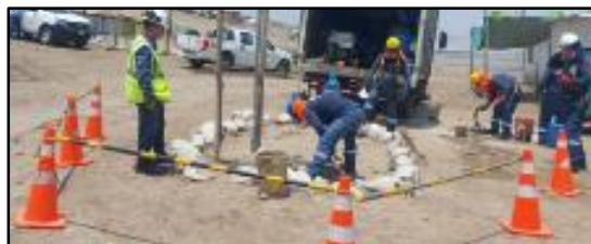
Foto 02: Buzón de la válvula de aire N°23
