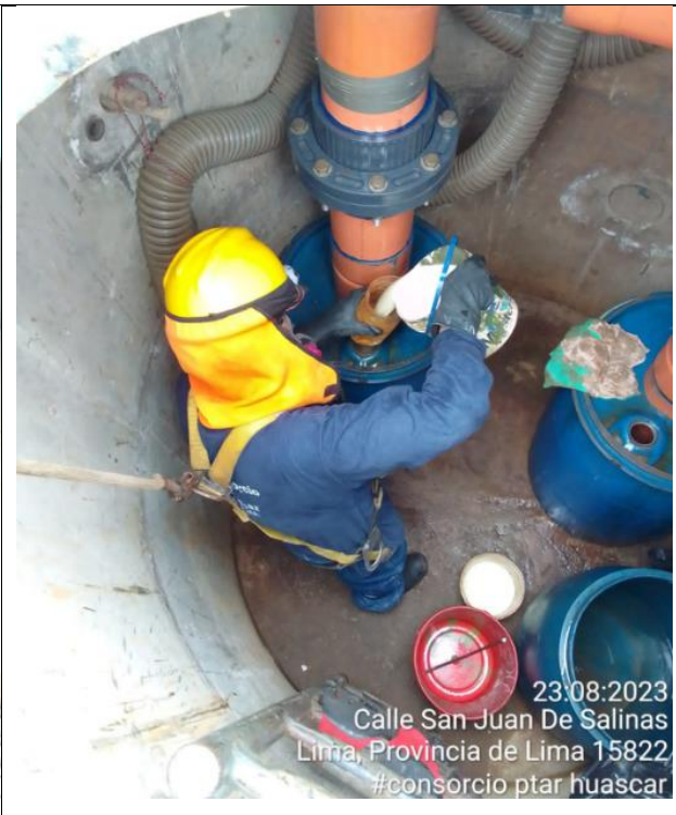
Fig. 04. Suministro de sulfato ferroso.
