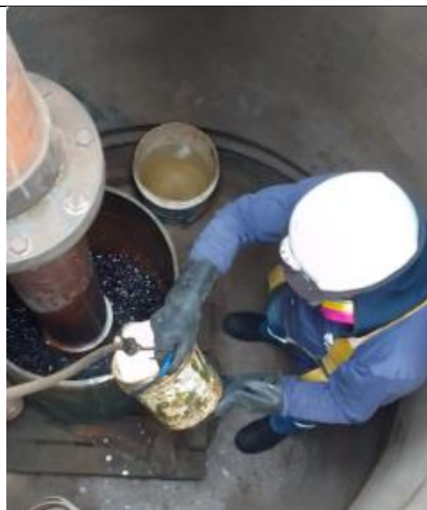
Fig. 04. Suministro de sulfato ferroso.
