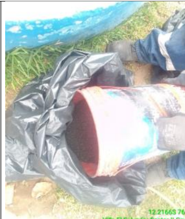
Fig. 02. Eliminación de Carbón activado.
