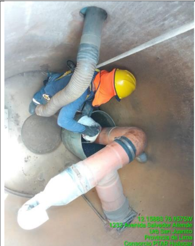
Fig. 04. Suministro de sulfato ferroso.
