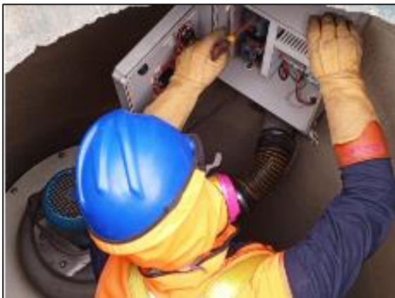
Nota1: Mantenimiento preventivo tablero de mando
