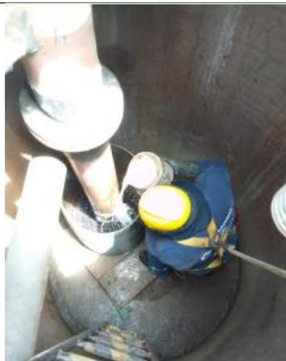
Fig. 04. Suministro de sulfato ferroso.
