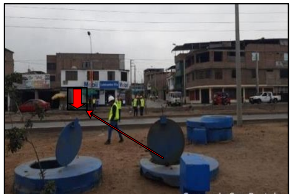
Foto 06: Trazo de cableado y ubicación
