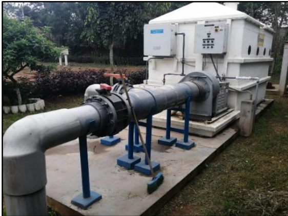
Nota1: Tanque Biofiltro
