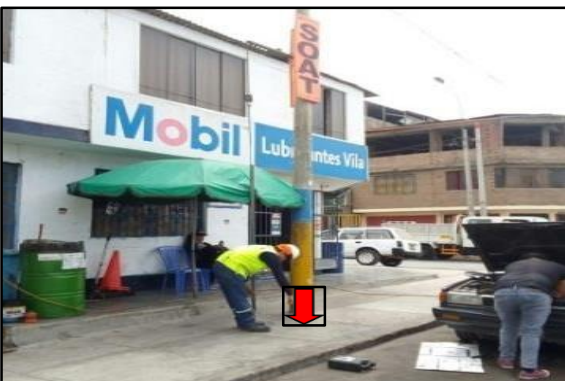
Foto 05: Punto de instalación del suministro
