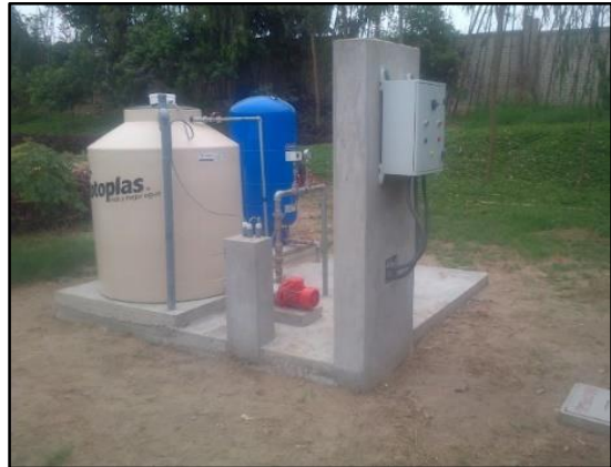
Nota2: Sistema Hidroneumático
