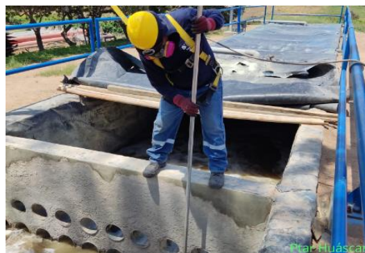
Extracción de residuos sólidos cámara Parshall
