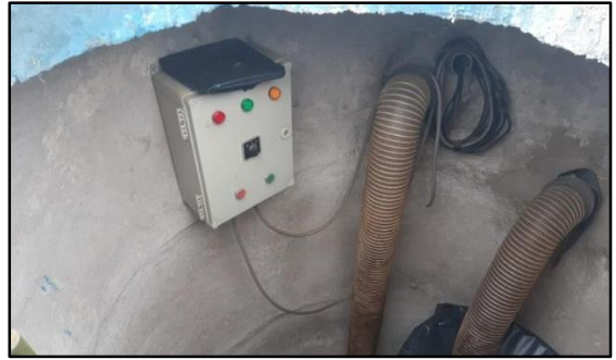
Foto 02: Caja de tablero para el sistema purafil
