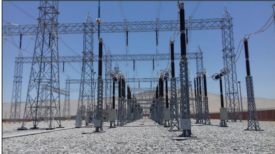
Figura 2.17. Subestación eléctrica de potencia
