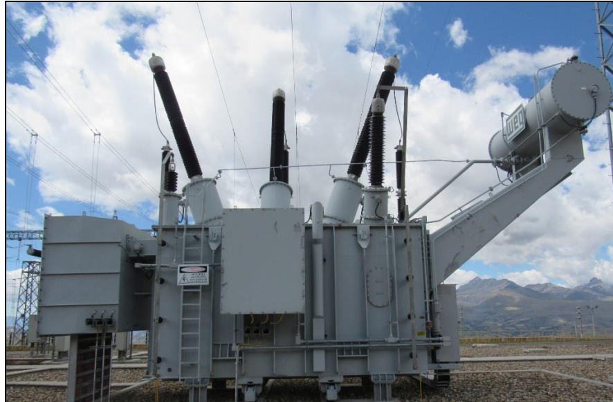
Figura 2.7. Transformador de potencia
