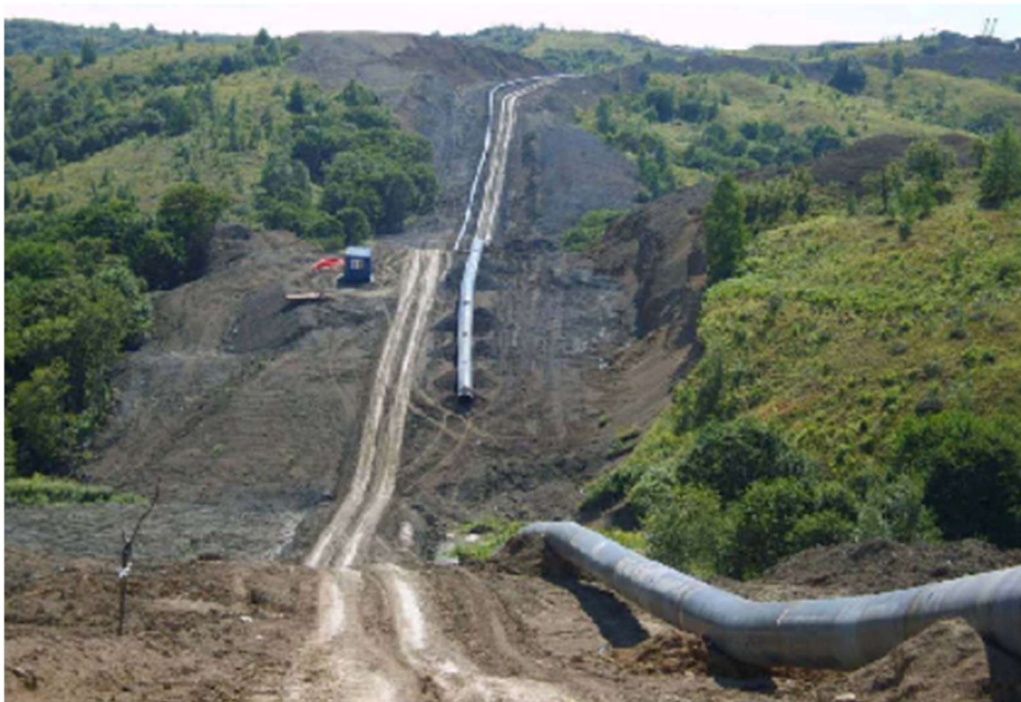
Colapso de tubería por causa de un deslizamiento de tierra
