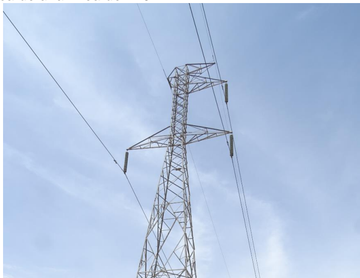
Estructura metálica de una línea de 220kV
