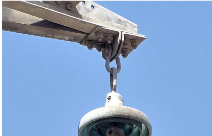
Herrajería lado estructura de una línea de 220kV
