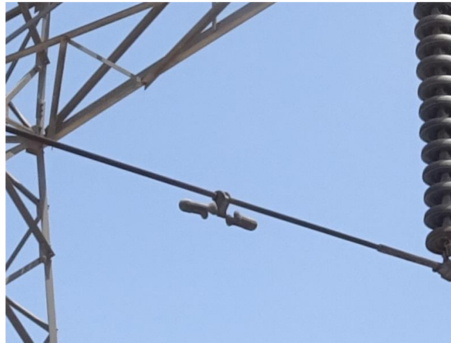
Amortiguador de una línea de transmisión
