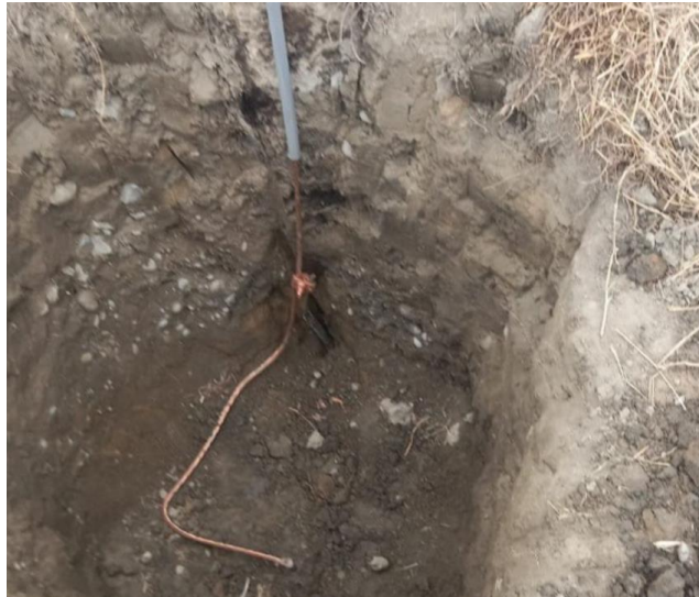
Conector de puesta a tierra de una línea de transmisión
