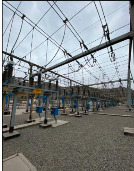
Sistema de Barra 1 60 kV SET Chavarría.
