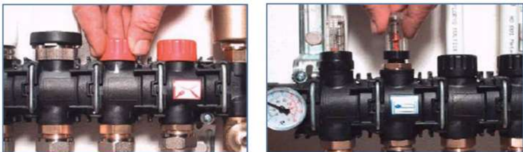
Figura 10: Termostatos y elementos de regulación y control
