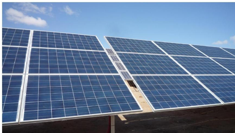
Seguidor con módulos extras para autoalimentado y comunicaciones inalámbricas.
