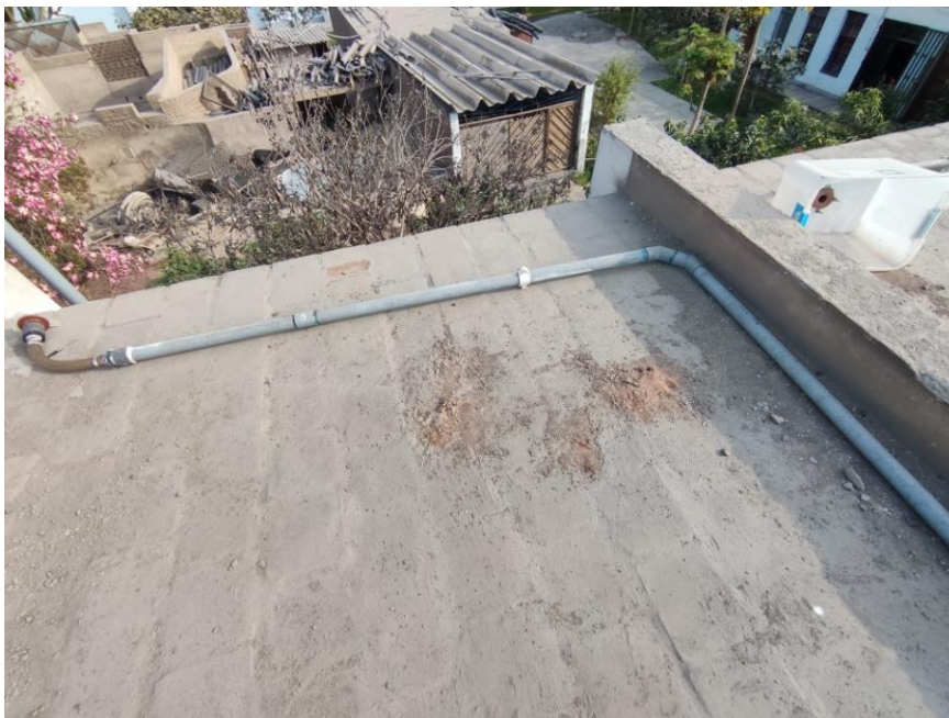
Línea desinstalada de Ø2"
