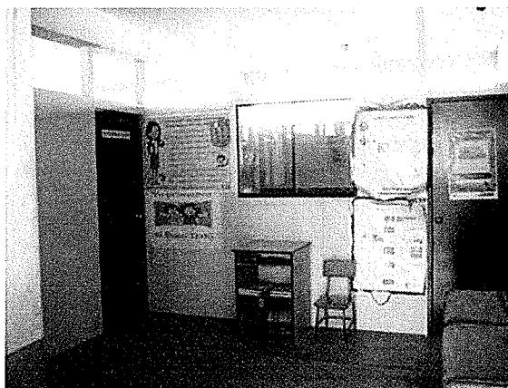
Foto N° 44. Presencia de tabiquería de drywall en la dirección.
