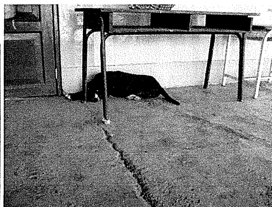
Foto N° 45. Grietas en piso debido a un mal procedimiento de compactación antes del vaciado del falso piso.
