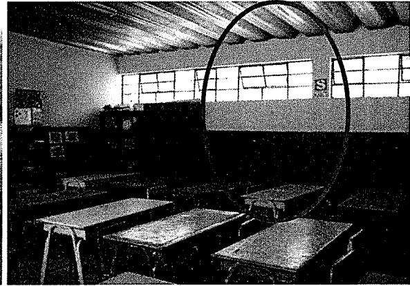
Foto N° 26. Problema de "Columna Corta"
