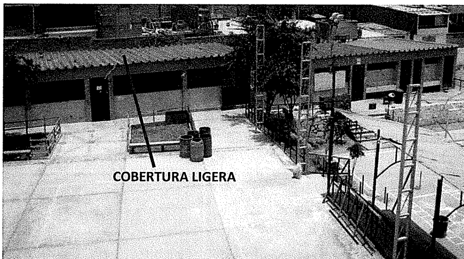
FOTO N° 24. Cobertura metálica que no da un adecuado confort térmico.
