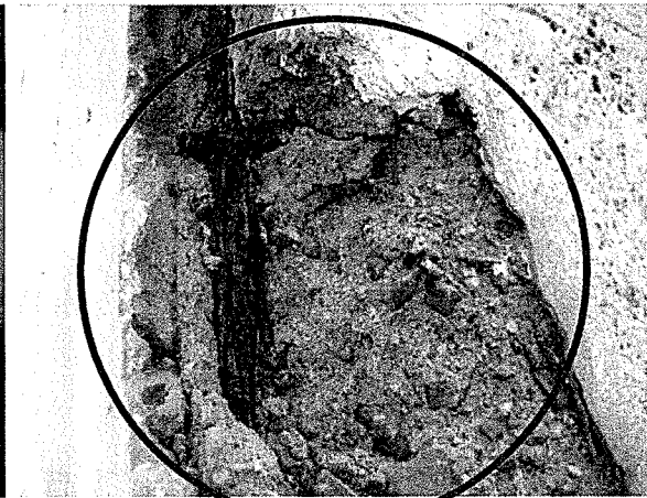
Foto N° 28. Desprendimiento de material y acero con alto grado de corrosión
