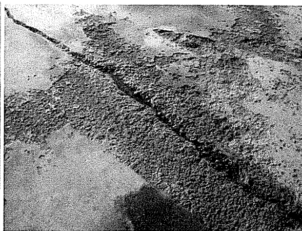
Foto N° 64. Presencia de grietas en patios
