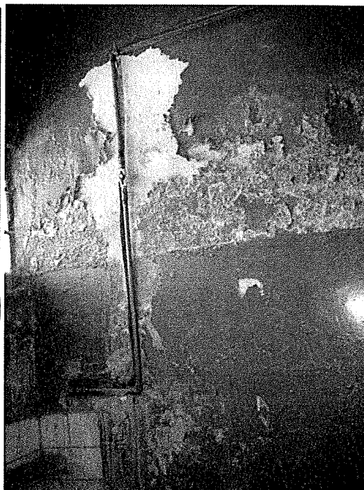
Foto N° 34. Efflorescencia en muros de edificación.
