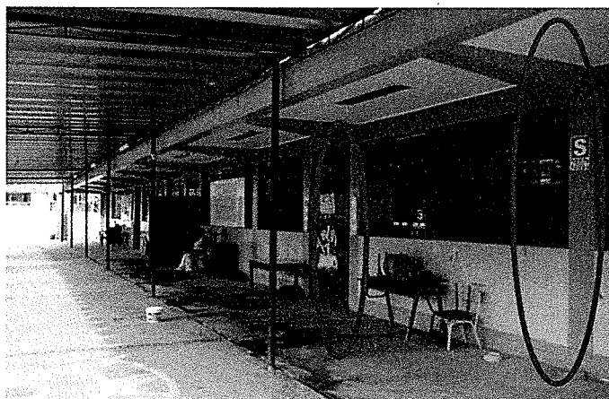
Foto N° 43. Problema de "Columna Corta"
