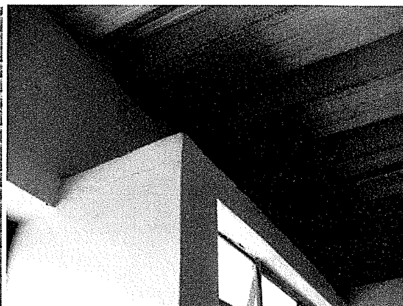
Foto N° 14. Inadecuada continuidad y uniones estructurales
