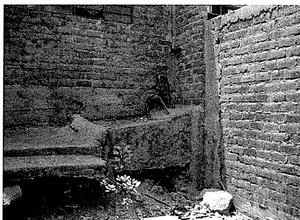
Foto N° 13. Precariedad en construcciones y malos procedimientos constructivos en los muros de albañilería confinada (excesivo espesor de juntas).
