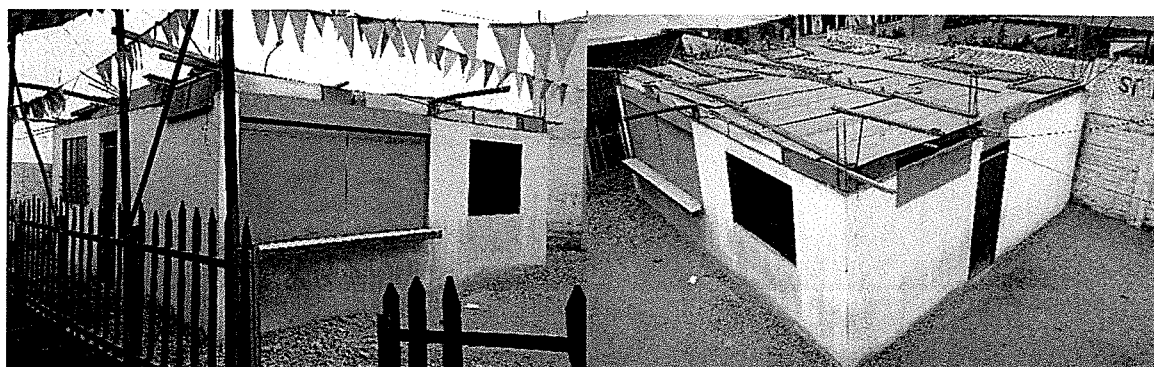
FOTO N° 48. Ha sido construida de manera artesanal y con materiales de baja calidad.
