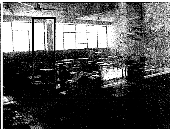
Foto N° 47. Efecto de columna corta.
