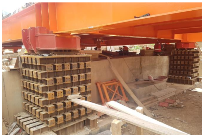
Figura N° 68 Apoyos giratorios en viga tirante
