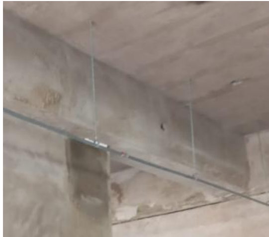
Imagen: Red de tuberías colgadas de PVC
